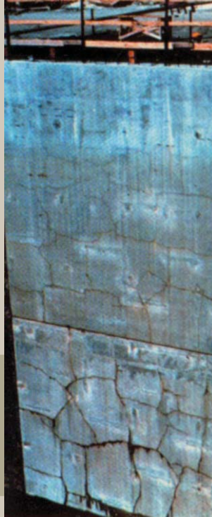
Trincas em forma de mapa causadas por limitação à retração térmica.
