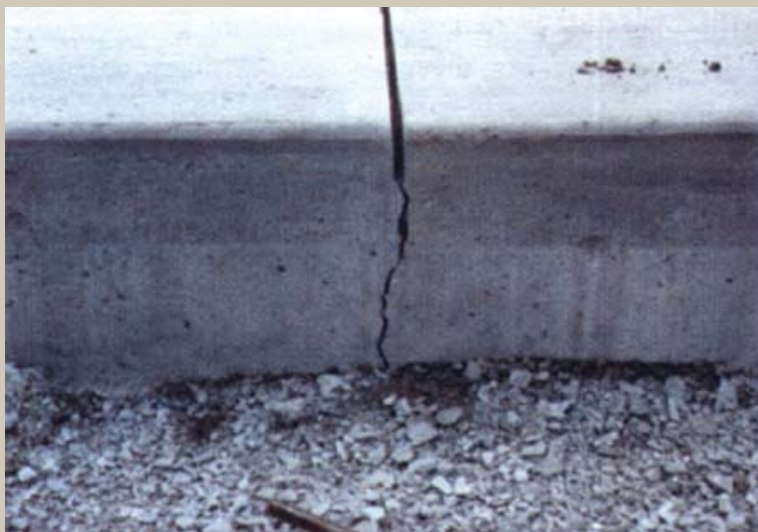
Junta de controle (serrada) e a trinca induzida em seu fundo.
