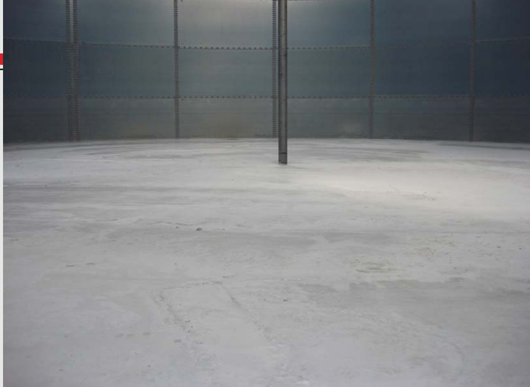
Pisos de tanques industriais exigem projetos bem sofisticados tanto para impermeabilidade quanto para corrosão, surgência de bolhas etc...
