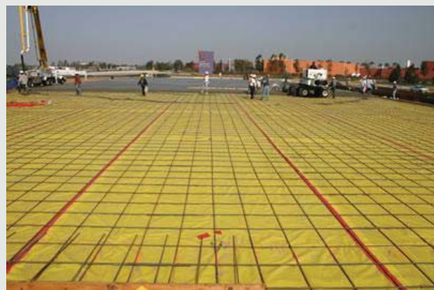
Boas barreiras contra o vapor, hoje, são fundamentais.
