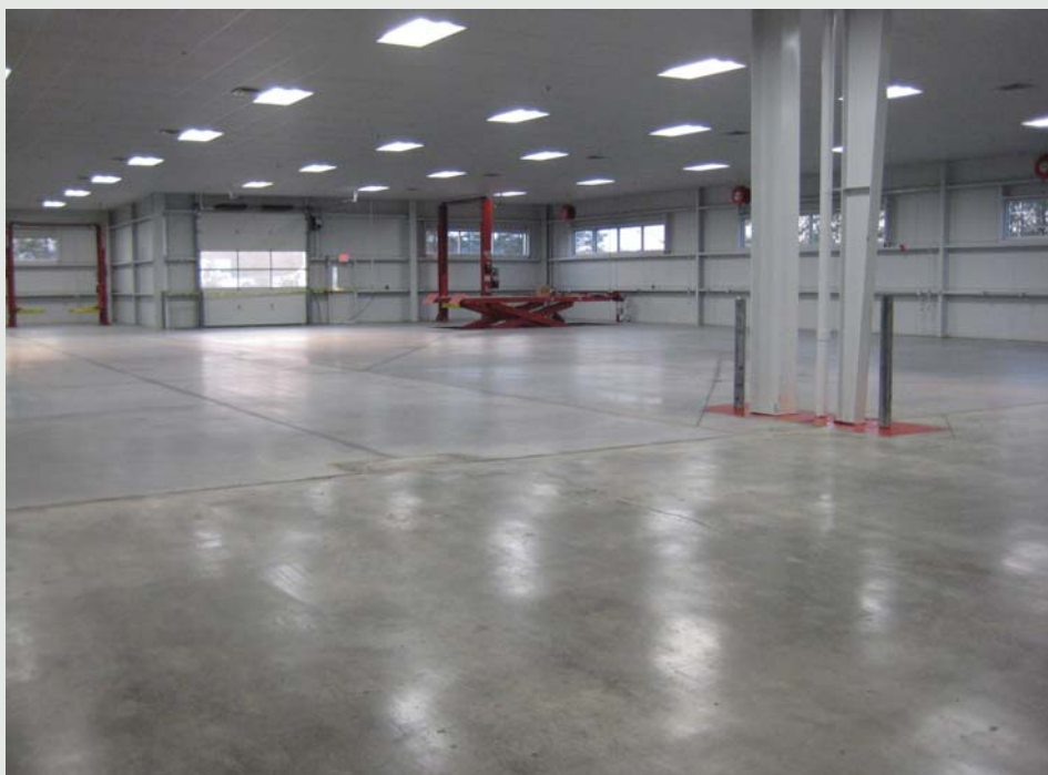
Secagem adequada do piso, antes da aplicação de qualquer revestimento é imperioso, assim como sua checagem através do teste TVA-OK.
