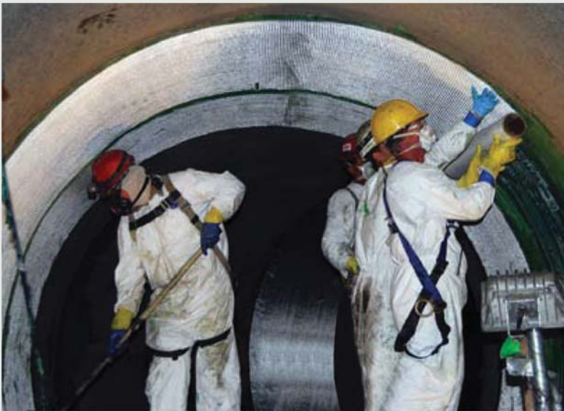
Instalação da manta de fibra de vidro estrutural ARMAGLASS NE, de modo a isolar o carbono do aço, evitando pilha de corrosão galvânica.
