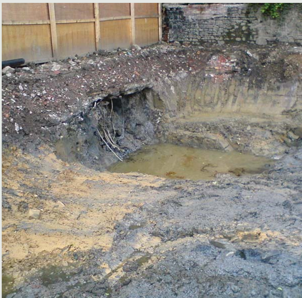
Contaminação do solo imediatamente abaixo da laje radier de um tanque que estocava alcatrão. Repare a laje radier cortada como referencial.
