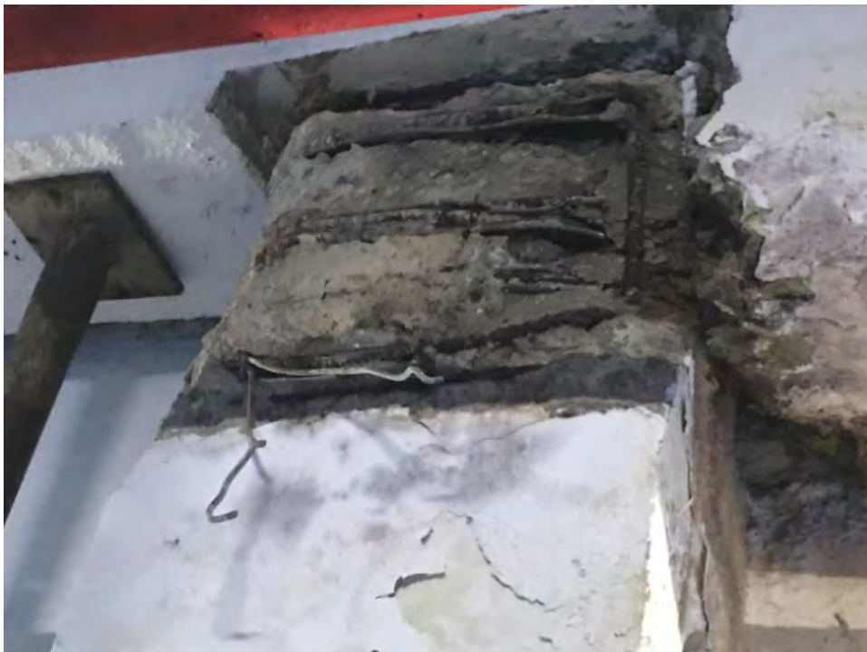
Processo de corrosão em peças estruturais de edificação: ideal para a PASTILHA Z.
