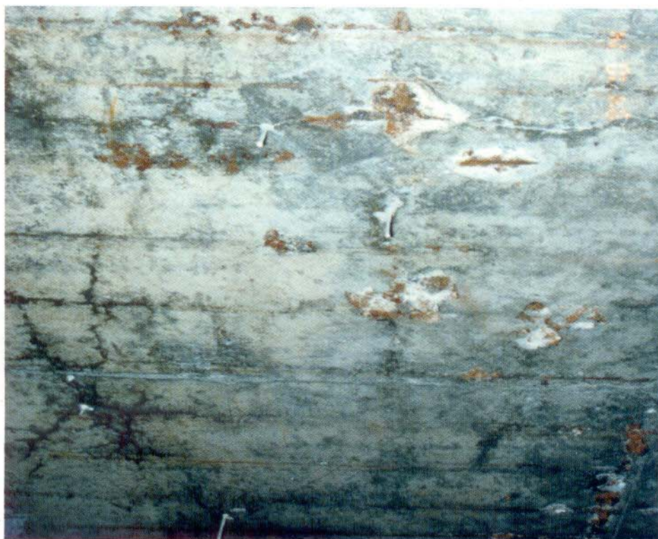
Lage de uma indústria próxima ao mar. Quando o teor de cloretos excede o valor limite, começa o processo de corrosão.
