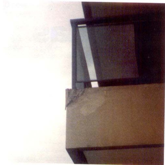
Normalmente, pela forma e materiais usados, há o comprometimento do sistema de ancoragem do corrimão.
