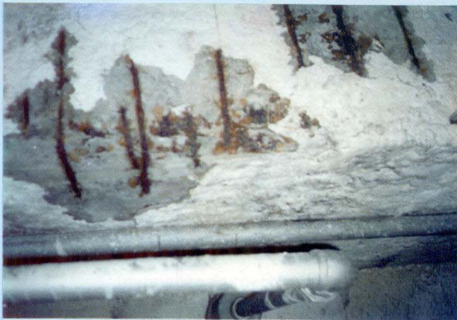
Corrosão Estrutural em tanque de indústria química
