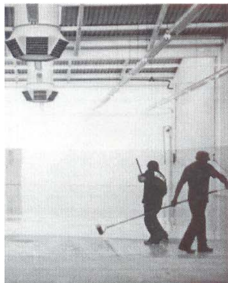
Normalmente são usados revestimentos epoxicos para proteger pisos industriais.
