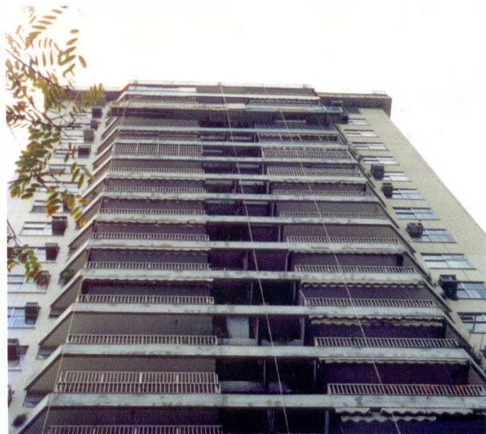
Do chão, avalia-se apenas o comprometimento da fachada. O acesso a alguns apartamentos permitirá melhorar a avaliação assim como verificar o comprometimento em relação ao interior do apartamento.
