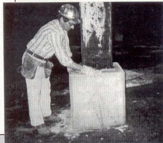
Argamassa com MC e armada com fibras acaba de ser desformada como recuperação de uma base de pilar
