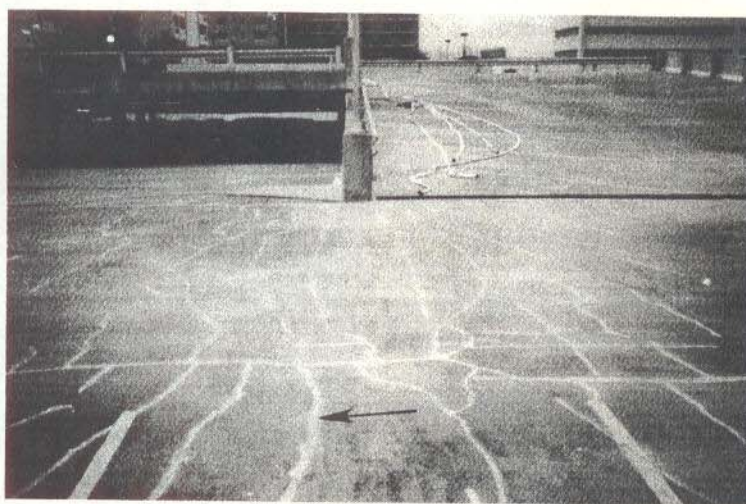
Trincas de momento negativo no piso do estacionamento de um shopping.
