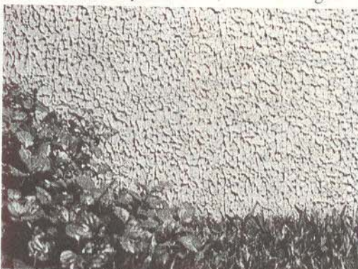
Luz do sol, umidade e mudanças de temperatura podem, facilmente, ocasionar a ruína do revestimento e pinturas exteriores.
