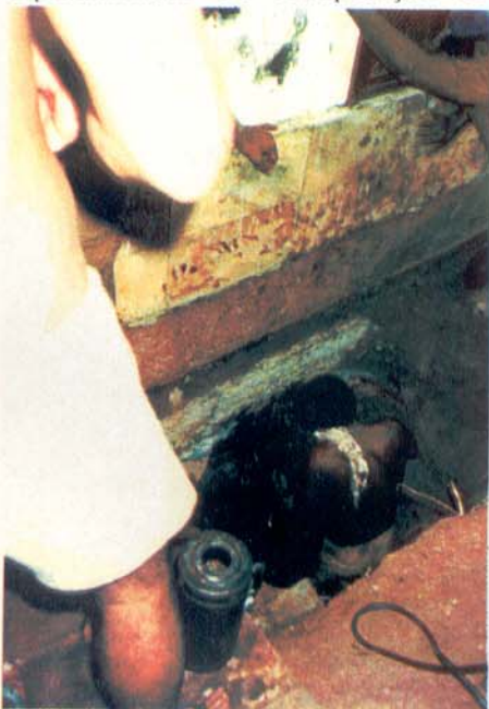
Sistema tradicional de cravação onde o tubo fica embaixo da base de fundação. Observe o macaco entre a base e o tubo.
