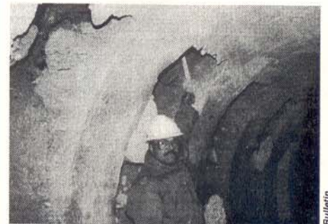
A hidrodemolição abriu "janelas" de até 1 metro de profundidade, remanejando o concreto deteriorado.
