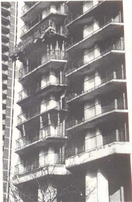
Serviços generalizados de recuperação de varandas poderão exigir trabalhos de escoramento nas varandas inferiores.
