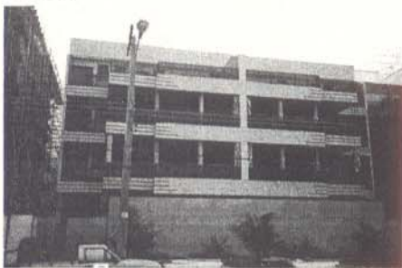
Neste prédio, acabado de construir, viu-se a necessidade de reforçar todas as varandas devido à ausência de critérios de cálculo adequados.
