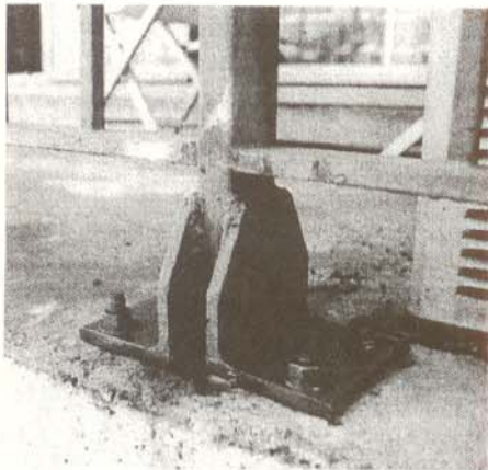
Uma alternativa para se reforçar as bases das grades é a instalação externa de cantoneiras em chapas de aço.
