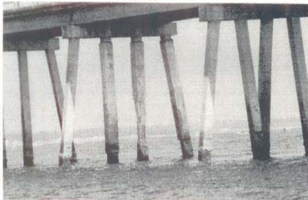
Uma das pontes Bryant Patton, na Flórida, apresenta estacas em concreto armado com significantes problemas causados pela corrosão
