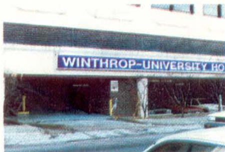
No teto da garagem deste hospital foi feito a P.C. com pintura a base de grafite
