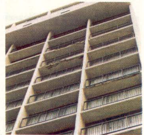
O prédio do hotel Sheraton, de frente para o mar e o estado das varandas
