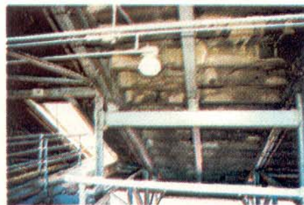
O estado das arquibancadas do estádio, antes dos trabalhos de recuperação e P.C.
