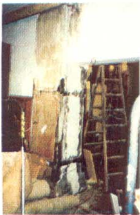
O estado de um dos pilares da Filene's
