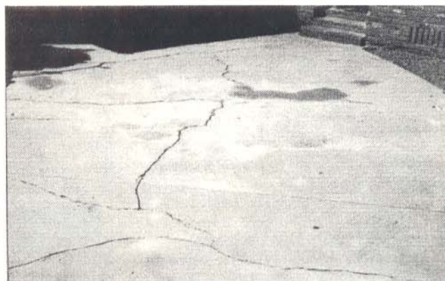
Extensas trincas e perda da aderência do material empregado. Deslocamentos eminentes.
