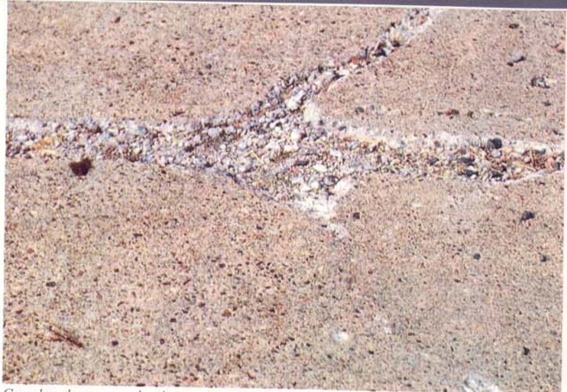
Grandes aberturas e deslocamentos juntamente com...
