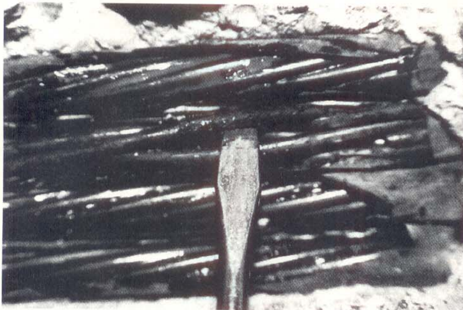
Após o corte do concreto, com o uso de uma chave de fendas, atesta-se o processo de corrosão em um fio de uma cordoalha.
