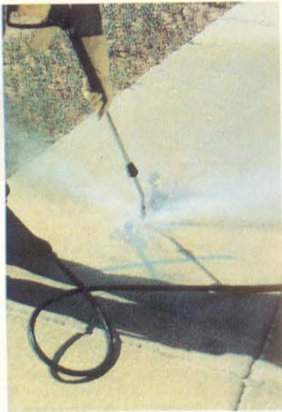
Após a remoção dos detritos é feito um hidrojateamento na superfície a ser protegida.
