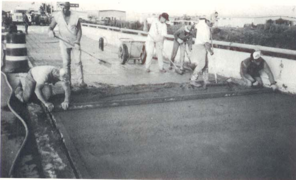
É comum aplicar revestimentos finos com argamassa estruturanda com fibras sintéticas, além de modificada, em tabuleiros de pontes.
