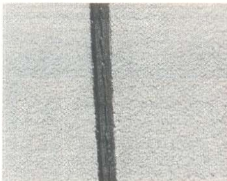
Falhas na coesão do mastique
