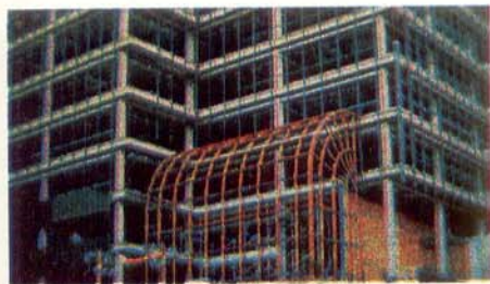
As lajes deste prédio no Missouri, assim com os pilares e as vigas, foram concretadas com fibras sintéticas, acelerando sobremaneira a construção.
