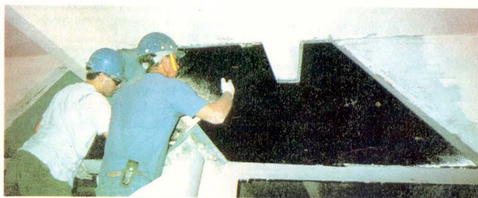
Operários aplicam o FIBROCARBON-E para reforçar uma viga com excessivas tensões de cisalhamento junto ao pilar.
