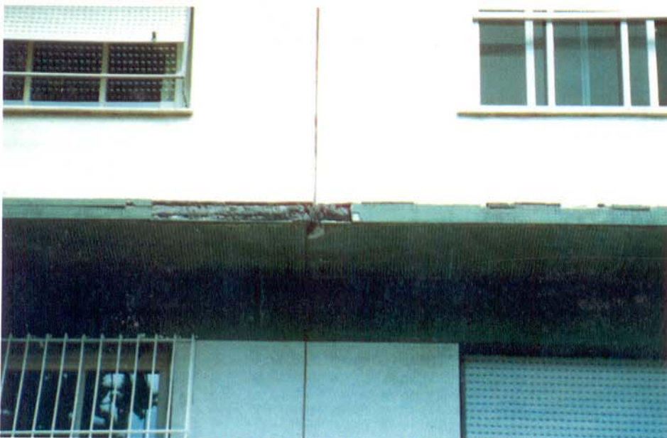
Percebe-se nesta junta da edificação que a junta sofreu um processo de compressão além do previsto, provocando esmagamento na borda da laje, com deslocamentos consequentes.
