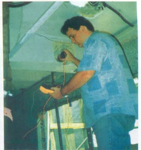
Usando-se a semi-pilha detecta-se a presença da corrosão em situações em que, aparentemente, não há qualquer sintoma.
