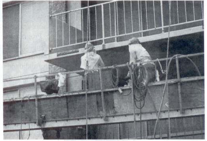
Marquises são elementos estruturais onde a presença de corrosão é particularmente perigosa e freqüente.
