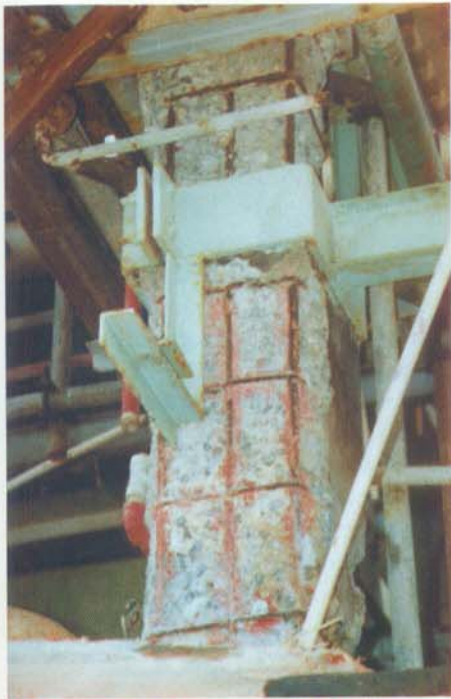
Este pilar, já sujeito a encamisamentos de reforço, apresenta as armaduras bastante comprometidas pela corrosão. Verificou-se que as armaduras da seção original também estavam em estado de corrosão.
