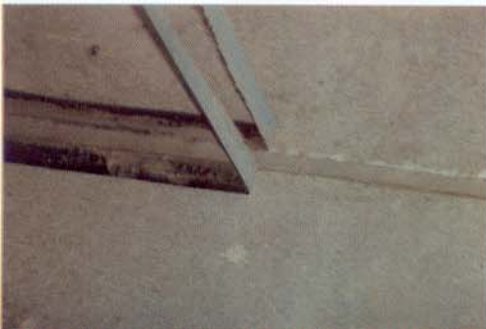
Após todos os trabalhos de calafetamento da junta, retira-se a fita protetora constatando-se a perfeição dos serviços.
