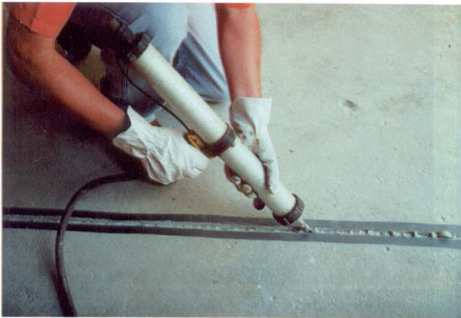
O calafetamento de grandes extensões de juntas com pistola pneumática poupa enormemente o técnico.
