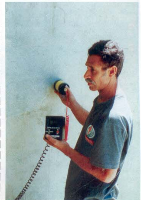
É importante fazer o mapeamento da estrutura próximo as áreas danificadas por corrosão, no intuito de se levantar possíveis comprometimentos.
