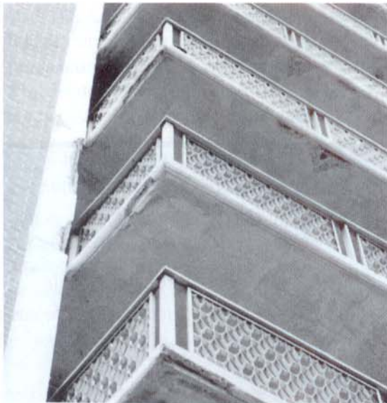
Desplacamento nas bordas das varandas
