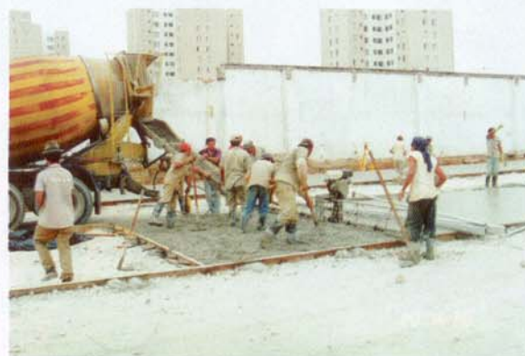
O intenso tráfego de operários durante o lançamento do concreto aniquila a "eficiência" da tela eletrosoldada perfurando, inclusive a lona plástica.
