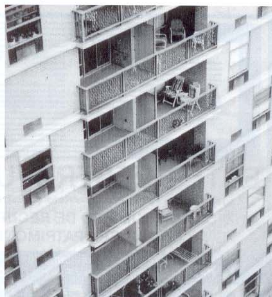
Varandas já recuperadas e reforçadas. Utilizou-se pintura elastomérica para a proteção das superfícies.
