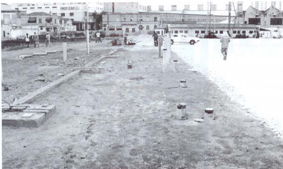
O sub-leito em primeiro plano já preparado para receber a sub-base de material granular (colchão de brita corrida) como evidenciado à direita da foto.
