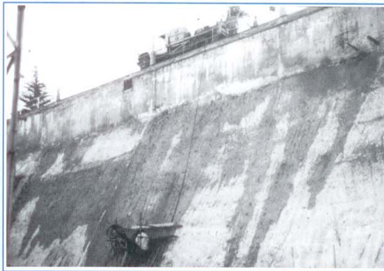
Nesta foto notam-se os vazamentos na face de jusante.
