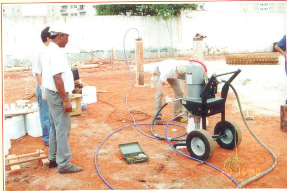
Os trabalhos de injeção de graut químico na estaca de teste. Ao fundo nota-se a mangueira conectada à cabeça da estaca. A estaca padrão encontra-se ao lado.
