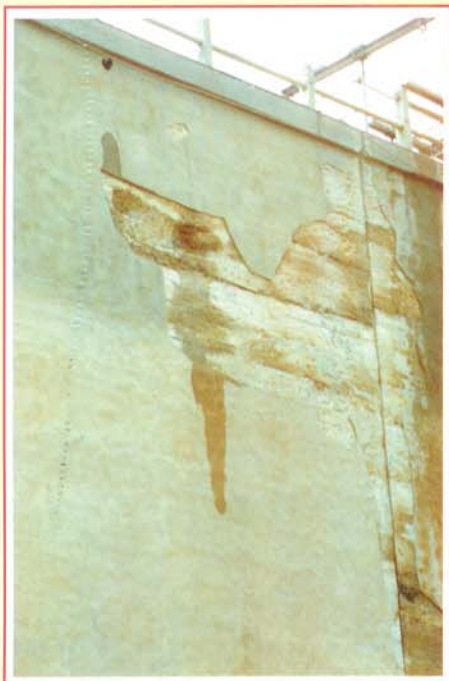
Descolamento da camada de recuperação em relação ao da parede da base.
