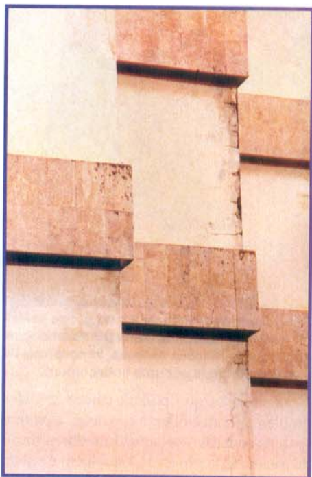
Particularmente, nesta edificação, a degradação da pintura começou em sua quina. Pode-se perceber as antigas trincas do emboço, muito comuns nas quinas das edificações.
