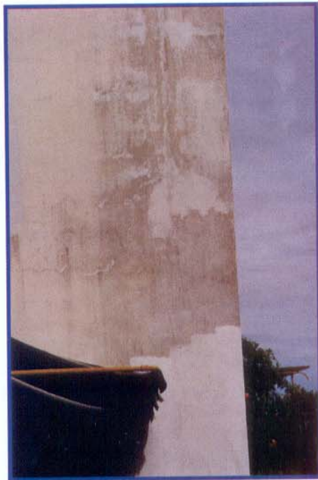
Nesta parede verifica-se perfeitamente o rompimento da película de tinta, tanto horizontal quanto vertical, formação de bolhas e bolor. O pior é que, sobre tudo isto, foi aplicada uma nova película de tinta.
