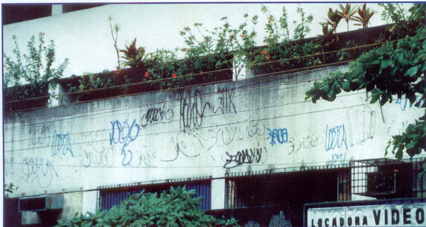
Danos por pichações são uma rotina nas edificações. É preciso conhecimento para removê-las e proteger a superfície, no sentido de evitar reincidências.
