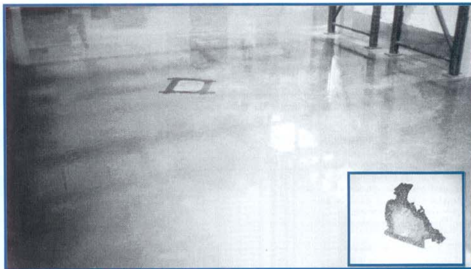
Esta pintura, num piso industrial, apresenta problemas devido à umidade no concreto do piso. O detalhe à direita mostra a situação do substrato, 30 minutos após a retirada do filme de pintura com uma espátula.
