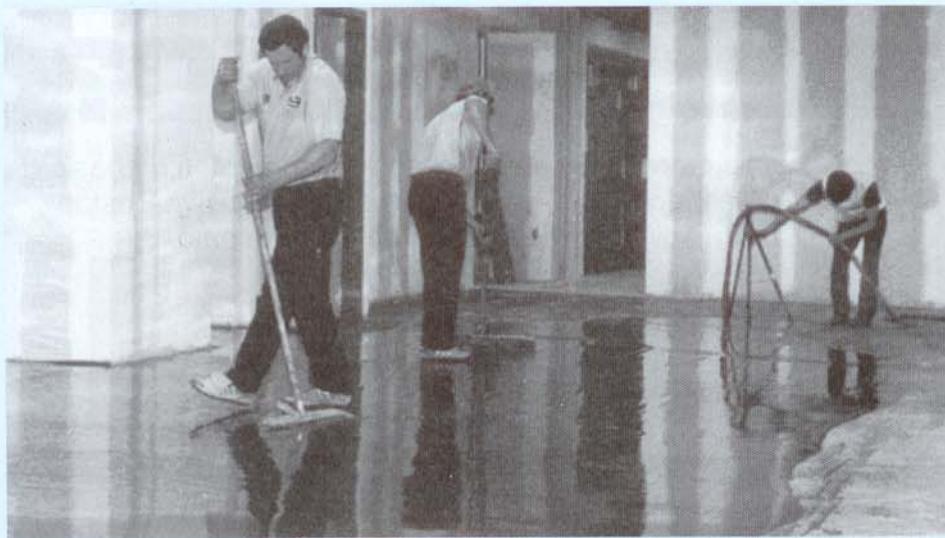
É intolerável em serviços de pintura de pisos protuberâncias maiores que 2mm ou buracos com diâmetro superior a 3mm. Muita atenção à relação pot-life/temperatura ambiente.
