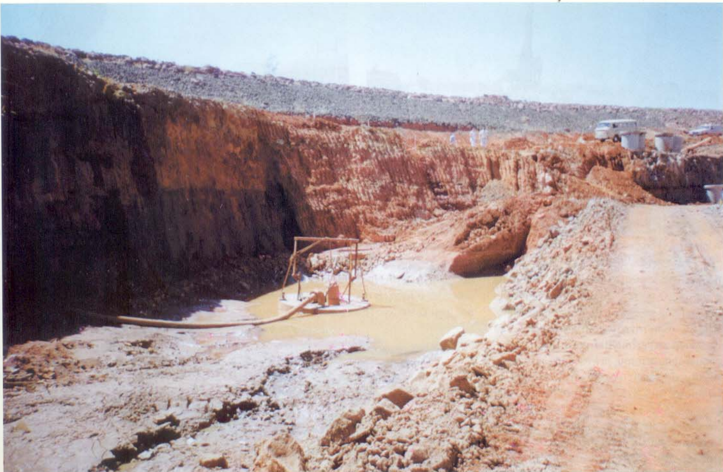
Vista da enseadeira pelo lado de jusante. Ao centro, o sistema de bombeamento procedendo a drenagem dos vazamentos que ocorriam através do trecho problemático. O principal processo de infiltração ocorria na interface da rocha (basalto) com o maciço argiloso (preenchimento).
