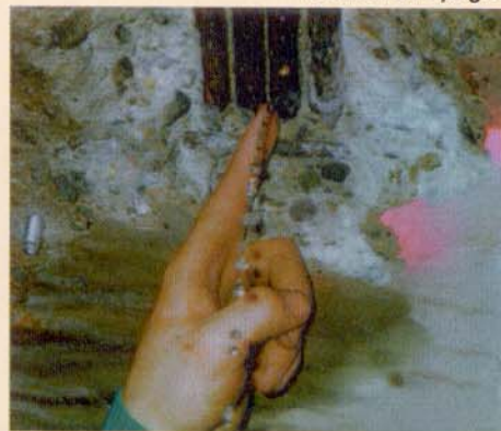
Através da abertura de uma "janela", constata-se a presença de água e corrosão.
