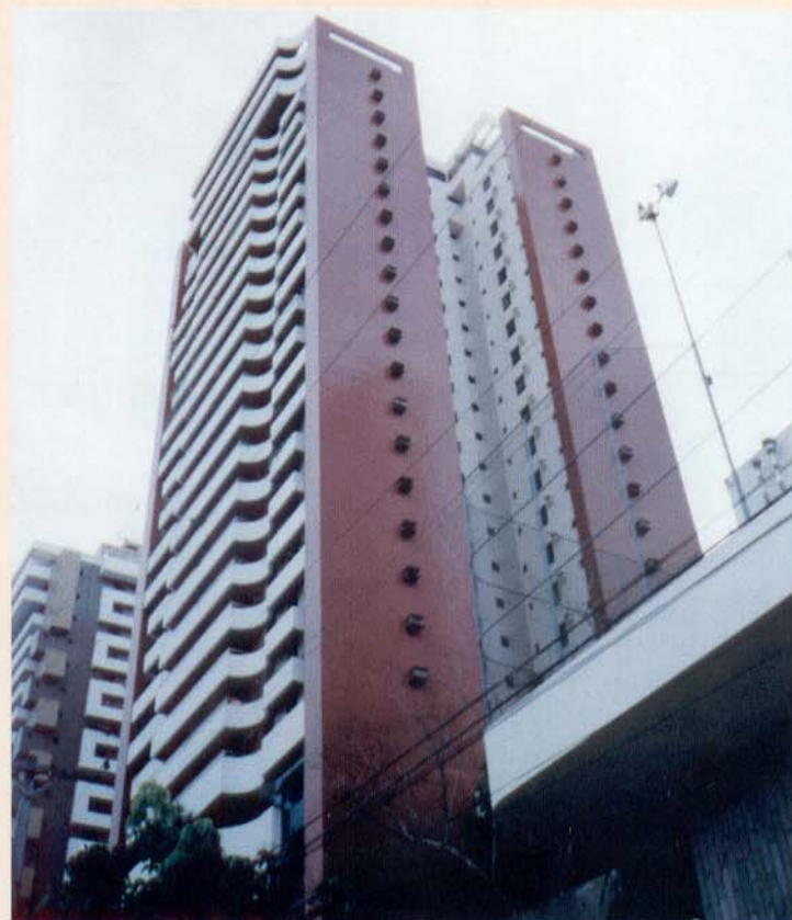
Prédio recém construído. Note a grandiosidade do revestimento das empenas cegas e fachadas, sem qualquer junta de movimentação. Problemas à vista.
