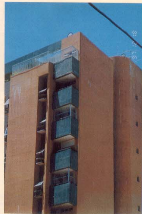
Sintomas generalizados de estufamento com presença de eflorescências (veja mais detalhes na Recuperar nº 13). Deslocamentos eminentes.
