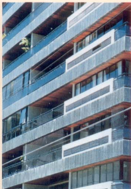
Note que o granito apresenta um sistema de fixação com parafusos que só deprecia a edificação. Deveria haver juntas verticais calafetadas a cada 6 metros ou entre peças.
