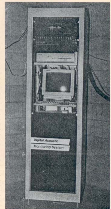
Este sistema coleta os dados detectados por acelerômetros instalados na estrutura protendida.
