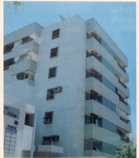
Panos inteiros sem qualquer presença de juntas. Sintomas generalizados de descolamento do revestimento (pastilhas).
