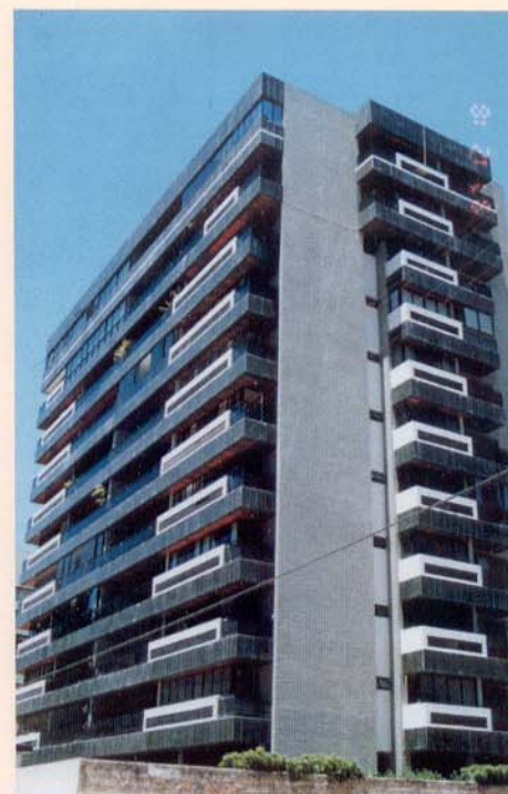
Revestimento em cerâmica (10x10cm) com sintomas de descolamento a diversos níveis. No revestimento em granito das varandas, providenciou-se o aparafusamento das pedras. A ausência de juntas provoca esforços de compressão no revestimento que, apresentando resistência à compressão superior, descola. O aparafusamento só atenua, às vezes, já que dependendo de como e onde é feita a fixação, os esforços de compressão desenvolvidos são superiores, arrancando-o, juntamente com o revestimento.
