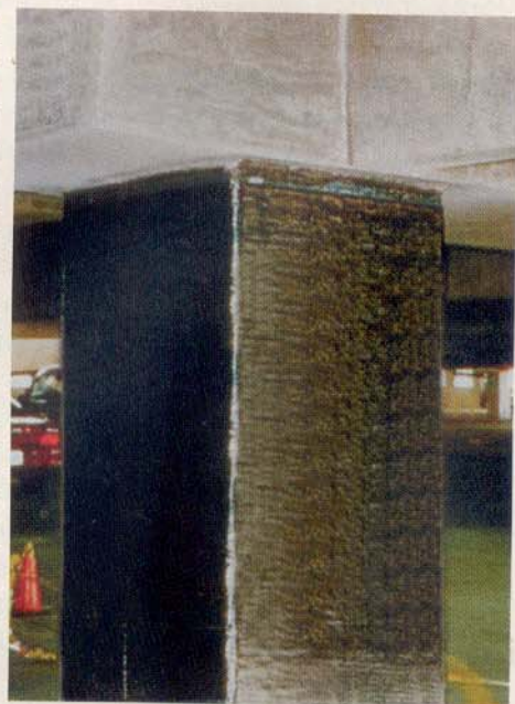
A técnica do Fibrocabon-E sendo aplicada no fundo de uma viga. Reforço a esforços de flexão e cisalhamento.
