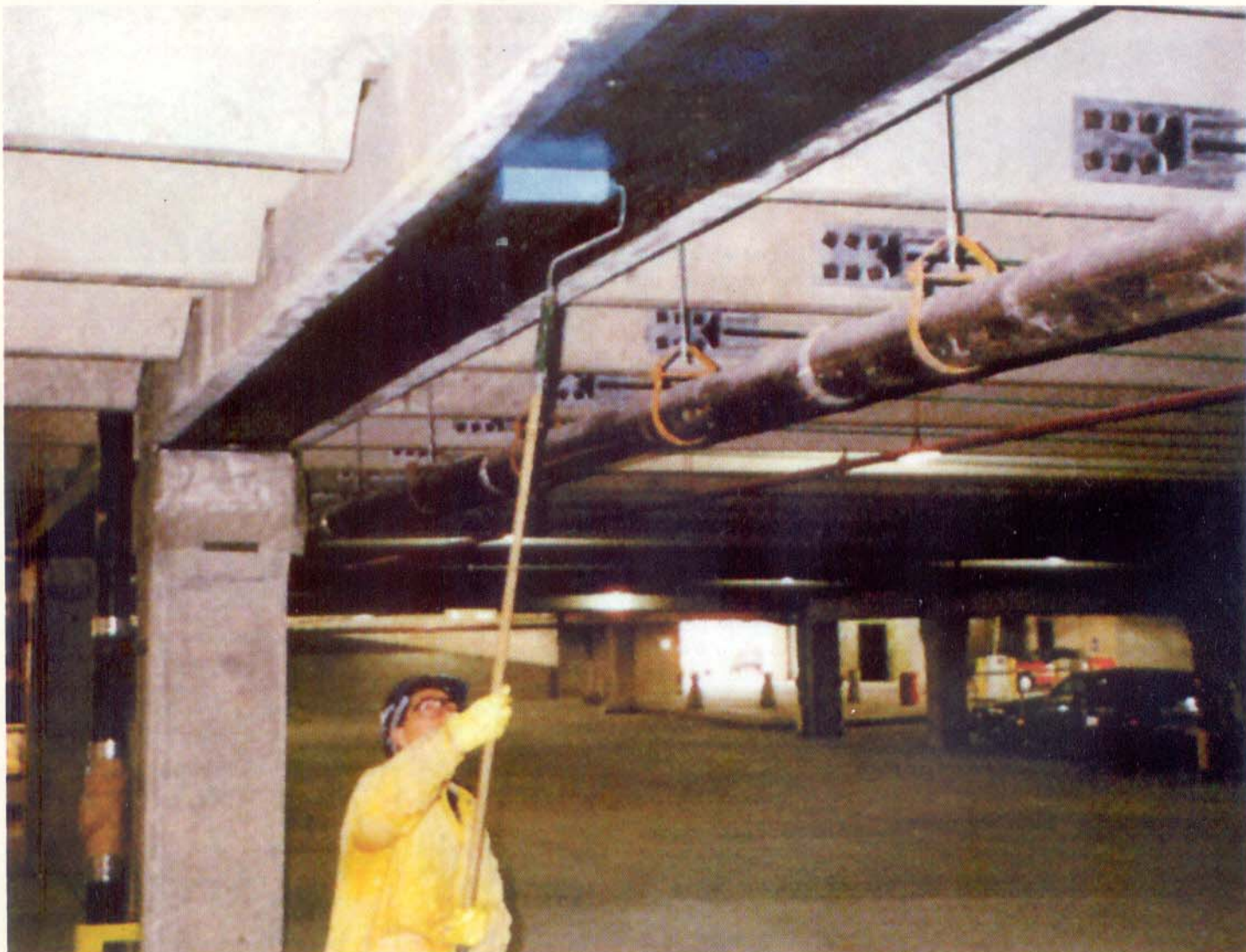
O reforço de uma viga à flexão com a técnica do Fibrocarbon-E.
