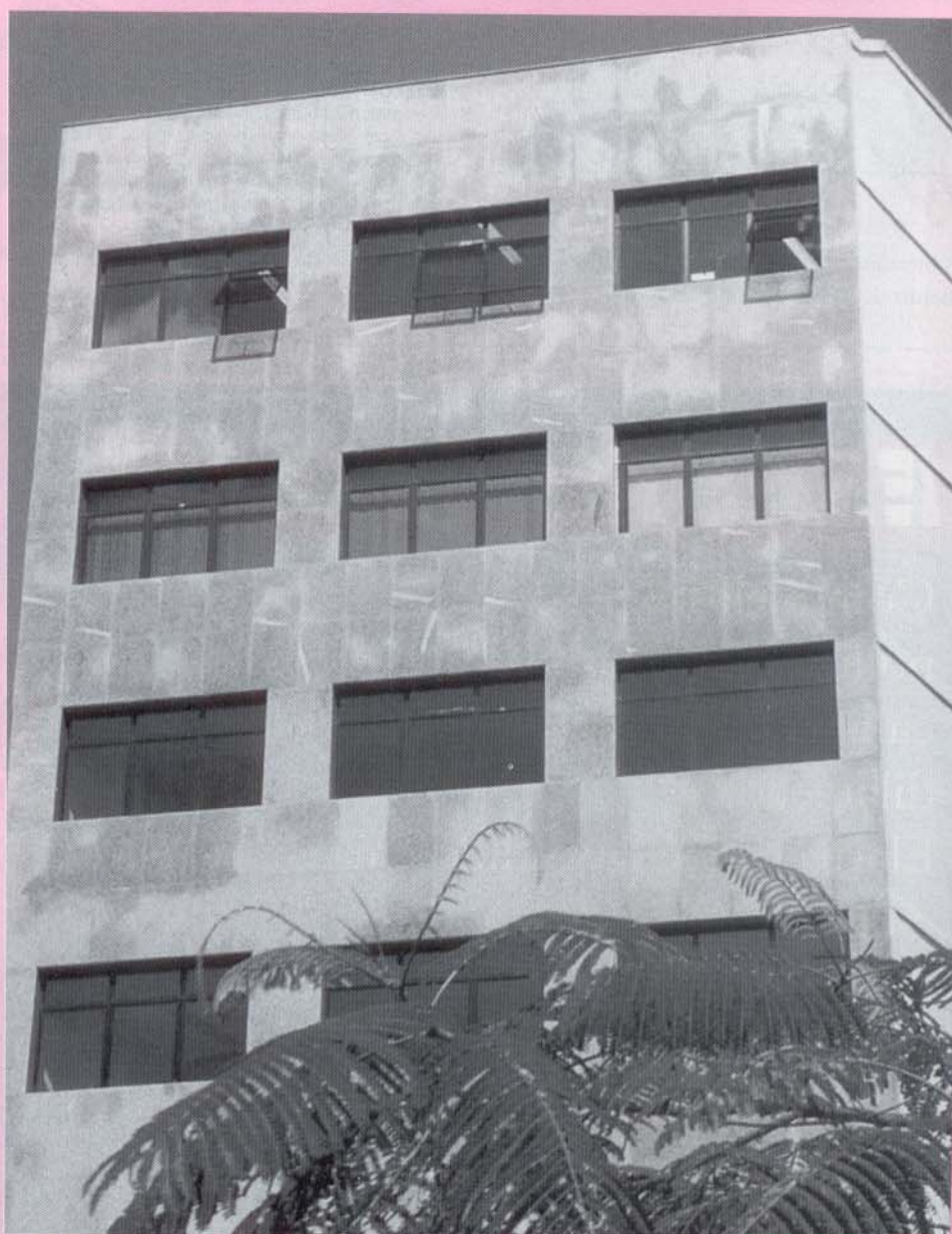
Juntas cegas sem qualquer proteção à penetração d'água, permitem o acesso da chuva que molha por trás (tardoz) todos os granitos, afetando sua estabilidade e criando eflorescências.
