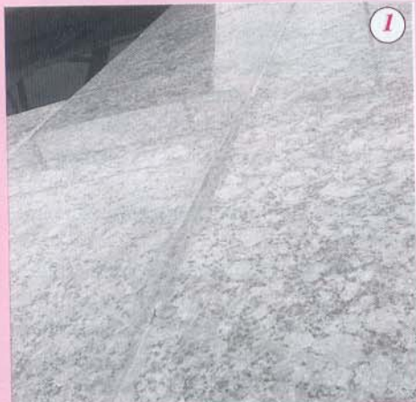
1 Presença de infiltrações ao longo das juntas que formam a fachada.
