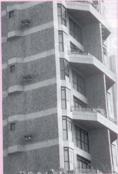
Em situações onde há utilização de materiais distintos nas fachadas, torna-se obrigatório o uso de juntas bem definidas entre eles, sem o que, pelo comportamento diferente existente haverá penetração da chuva para dentro dos apartamentos.
