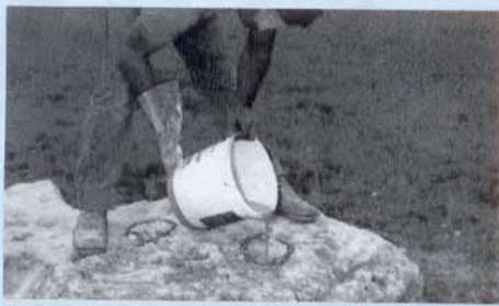
Após a furação basta verter a calda feita com o cimento expansivo.
