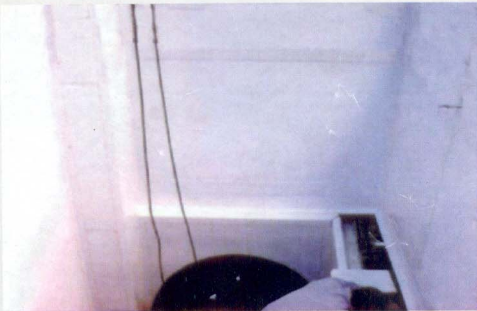
Revestimento feito com sistema de PVC em um trecho de uma ETA.
