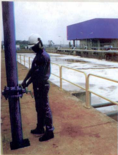
ETE Parque Novo Mundo: 2,5m 3 /s de esgotos tratados.
