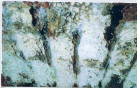
Zona atacada pela CIM. Note a situação das armaduras e, particularmente, a do concreto.
