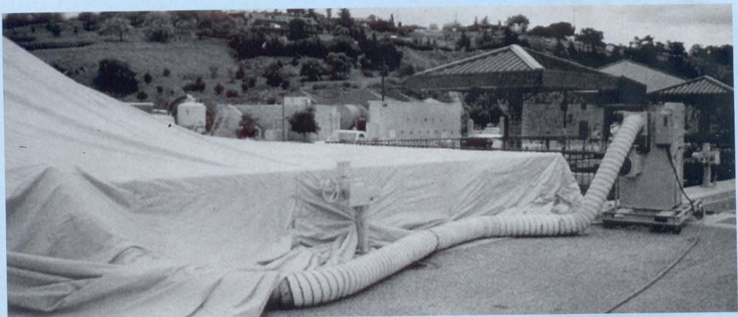
Equipamento de desumidificação na ETA de Santa Clara, Califórnia.
