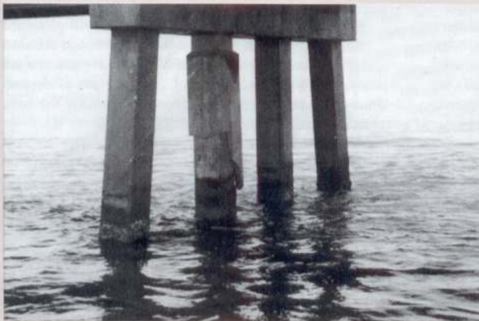
Situação comum de estacas recuperadas e reforçadas com jaquetas de concreto armado, ignorando-se a causa do processo de corrosão.
