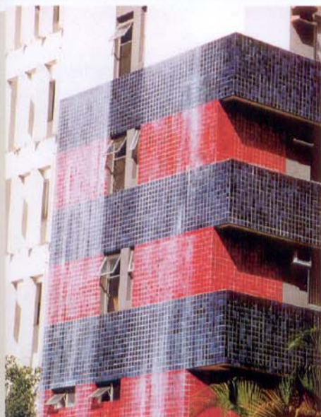
Pintura recentemente executada. Repare que pela qualidade e, particularmente pela quantidade da resina empregada, o pigmento soltou-se do sistema, comprometendo o revestimento cerâmico.
