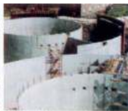
Estações de tratamento de esgotos.
