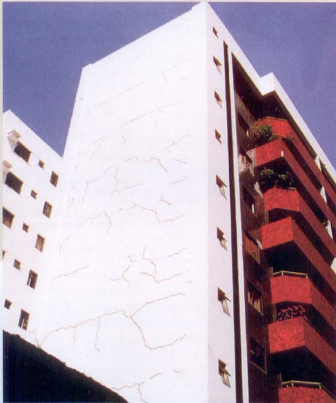
Fachada particularmente exposta à ação do tempo e toda comprometida pela surgência de trincas. Dever-se-á, primeiro, proceder ao remanejamento da película existente, que se encontra sem qualquer função. Após a abertura e calafetamento com elastômero à base de poliuretano ou polisulfeto, é sugerida a aplicação de um PP específico e uma tinta elastomérica.
