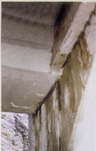
Infiltrações nas juntas inferiores.
