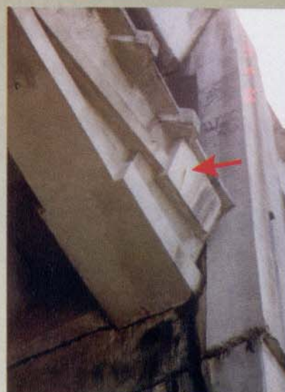
Indícios de corrosão no sistema de ancoragem dos cabos de protensão.
