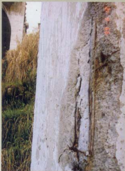
Trincas e grandes deslocamentos provocados por altos níveis de corrosão, certamente existentes na recuperação anterior.
