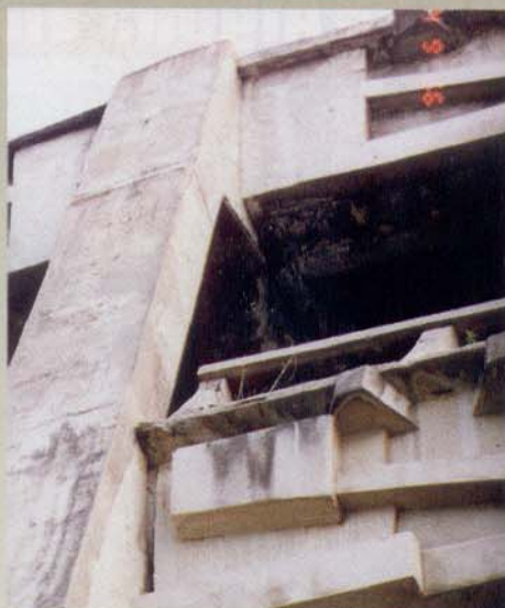
Infiltrações nas juntas superiores.
