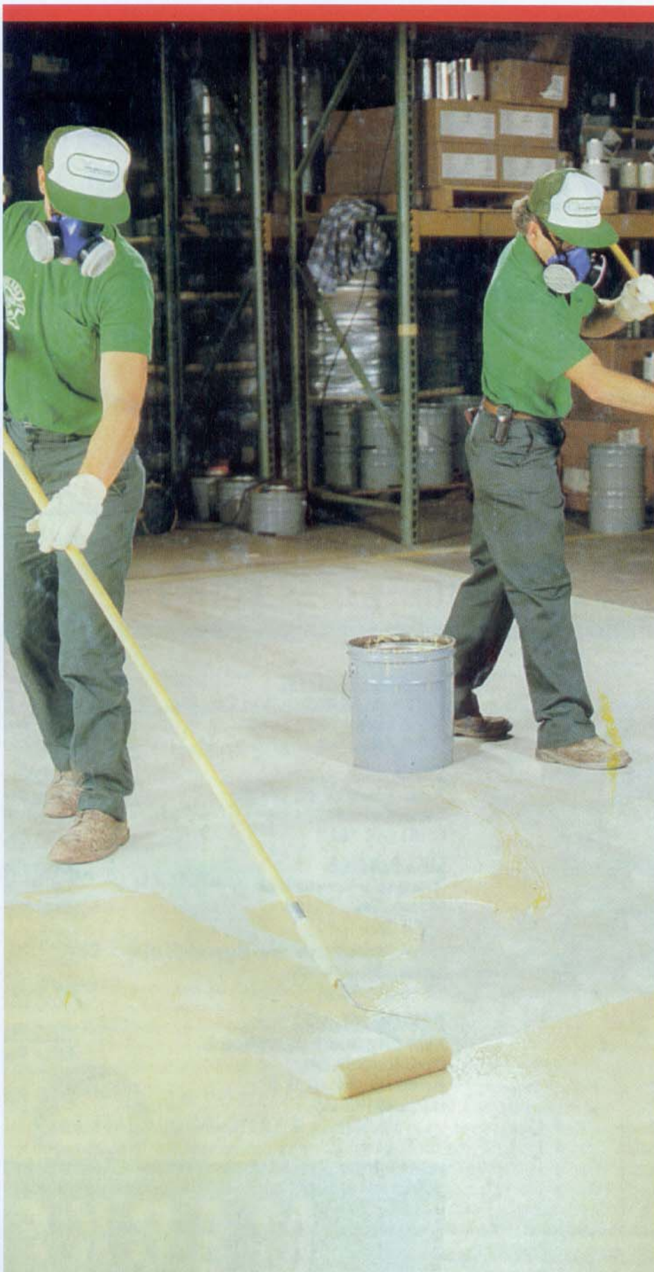
Antes de refazer a aplicação da pintura em pisos epóxicos com histórico de ruína, torna-se necessária a investigação da umidade dinâmica através do piso.
