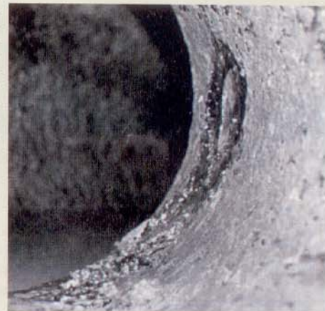
Pite redonda e profunda sob o tubérculo (já removido) em uma tubulação que conduz o L.A.T.
