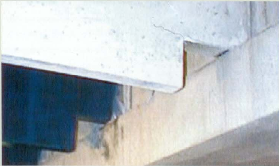
Figura 1 - Trincas de cisalhamento junto ao apoio. Para corrigir este problema e aumentar sua capacidade para cisalhamento, as vigas foram envolvidas com fibra de carbono, formando um U.
