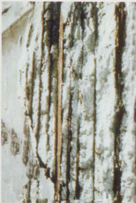
O estado das paredes das ETEs com a ação da CIM.
