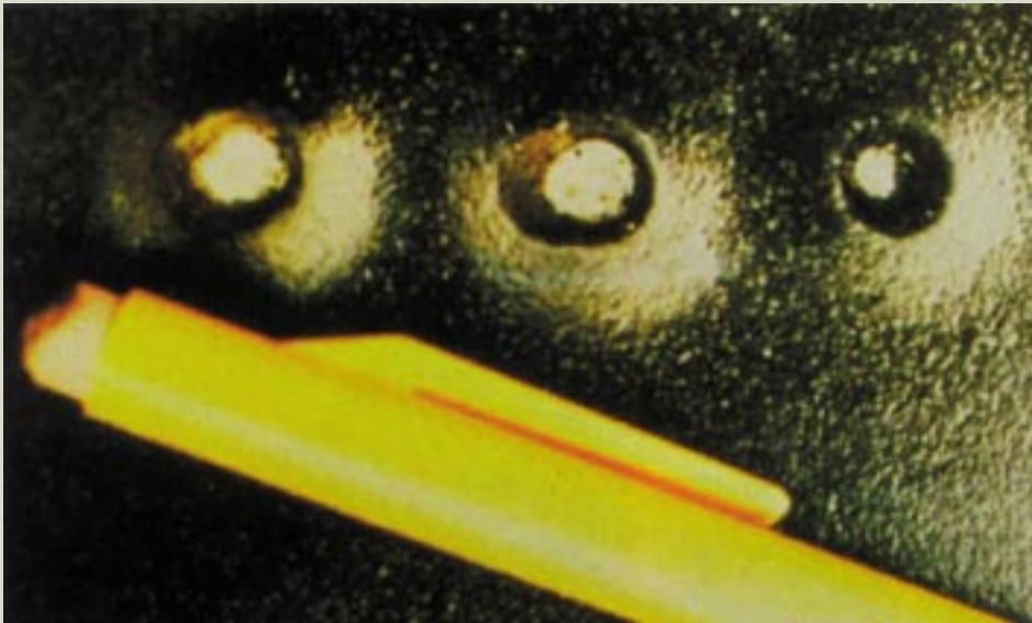
A película deste revestimento sobre concreto apresenta furos como resultado do contato direto com produtos químicos ricos em sulfeto de hidrogênio (H 2 S). A referência é uma caneta e o tempo de exposição é de 18 meses.
