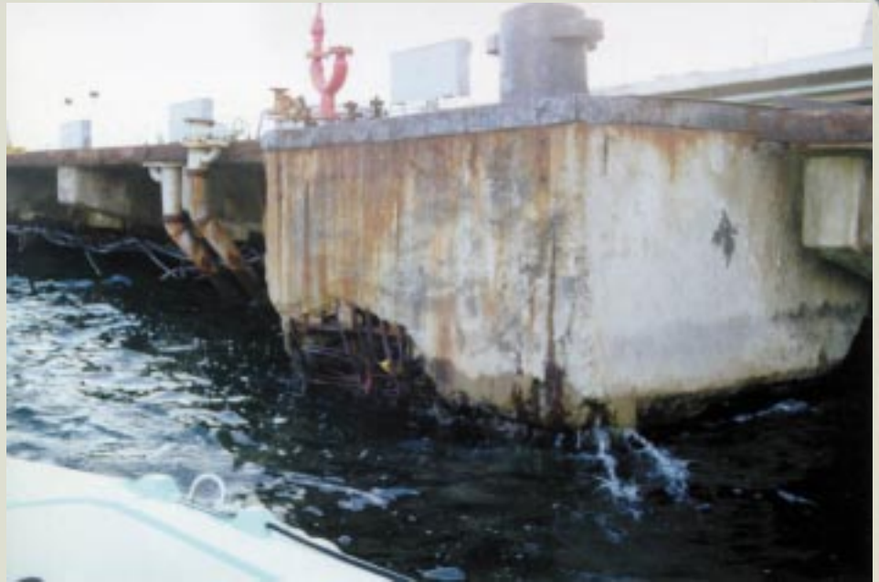
Concreto armado na zona de variação da maré. Corrosão nas armaduras e destruição do concreto ou destruição do concreto e corrosão nas armaduras. A ordem não importa.
