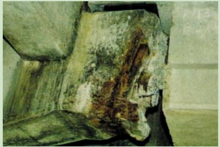
Figura 3 - A extremidade da mesma viga com evidente dano por corrosão na ancoragem da protensão.
