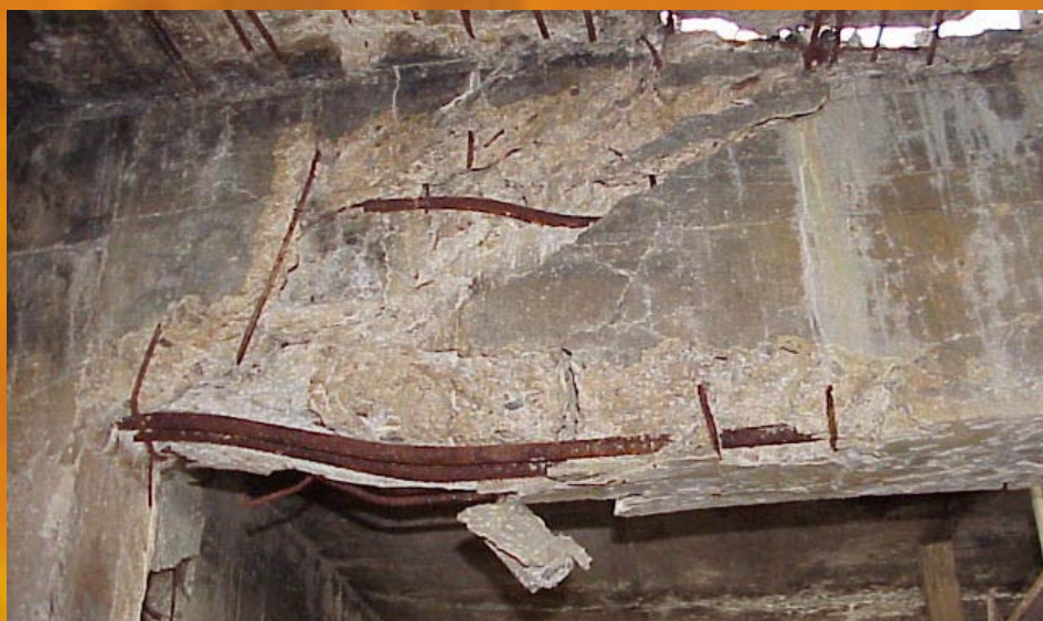
Figura 1 - Estado de completo comprometimento de duas vigas, após sinistro por fogo. As lajes, como na foto de baixo, também demonstraram grandes deformações.
