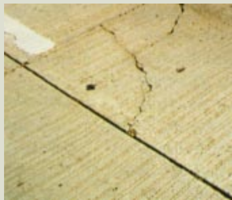
Figura 4 - Interseção de multiplas trincas.
