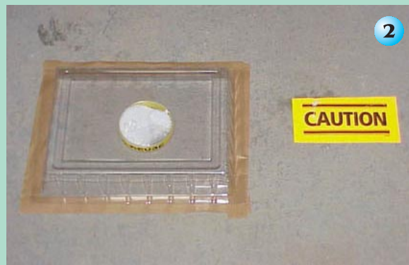
Análise do perigoso vapor d'água que vem do piso com o TVA-OK. Este teste evita a ruína posterior do revestimento aplicado sobre o concreto.
