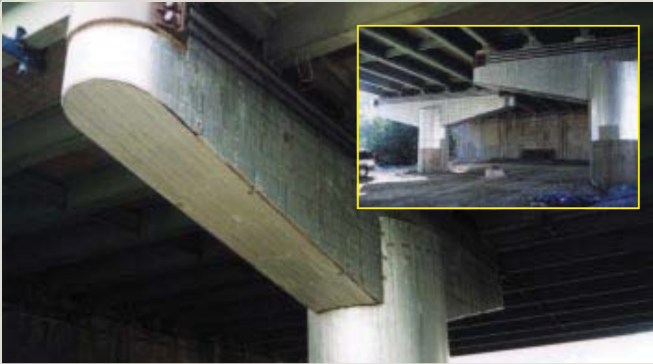
Diversas travessas e pilares na ponte I-95 em Richmond (Virgínia) com aplicação de MAZ.
