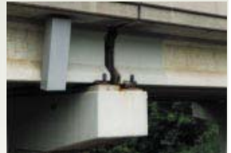
Devido a infiltrações pelas juntas de dilatação, ocorreram sérios processos de corrosão nas extremidades das longarinas...
