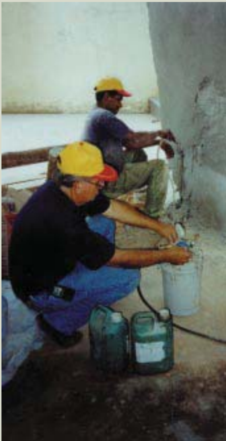
As trincas e fissuras foram injetadas antes do trabalho de reforço.
