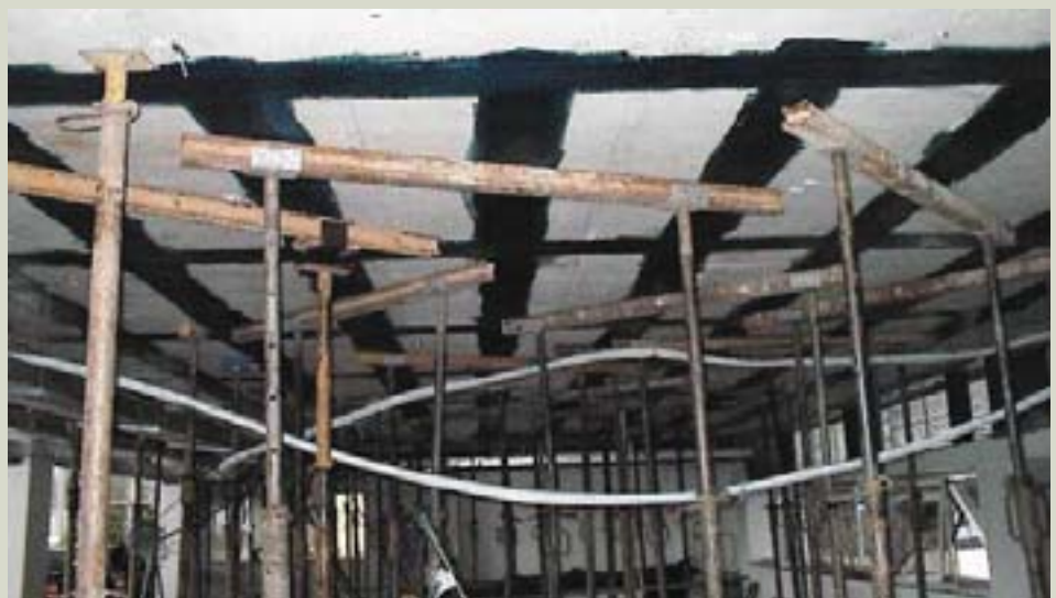
A laje após o reforço com fibra de carbono. Repare que o posicionamento das escoras foi paulatinamente alternado devido a interferência com os locais de colagem da fibra de carbono.
