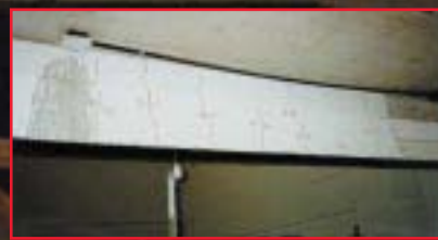
O estado de fissuramento na viga V11a durante o carregamento, sob outro ângulo.
