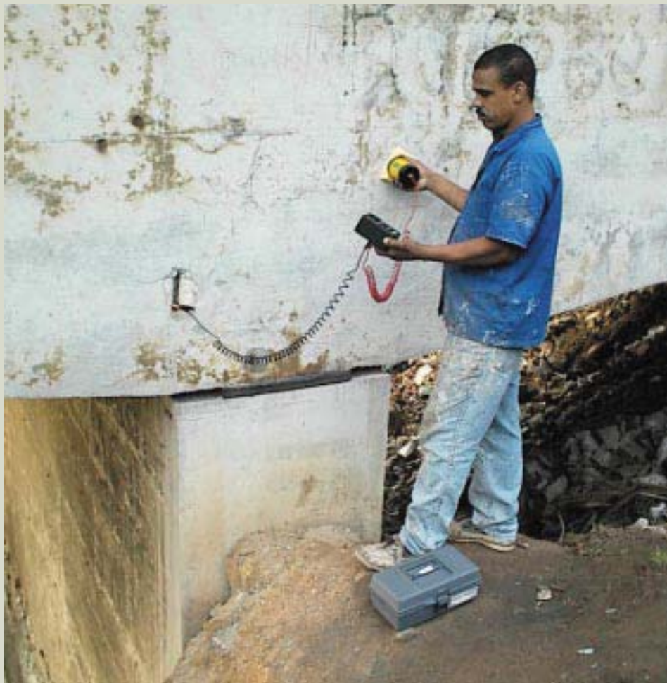
A investigação dos potenciais de corrosão, com o objetivo do mapeamento dos sintomas, em uma viga caixão sobre o pilar em um viaduto.
