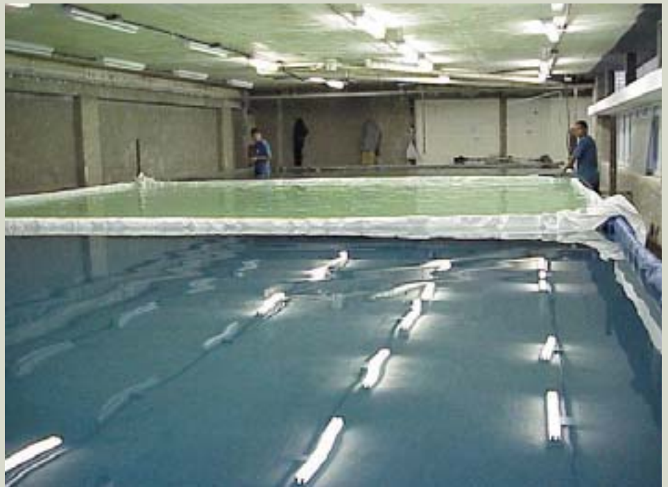
A prova de carga atingindo o último estágio de carregamento. Sobrecarga máxima atingida de 600kg/m 2 .
