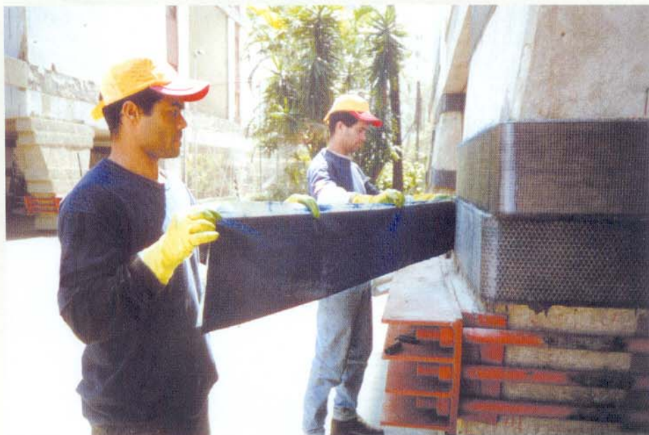
O reforço de pilares exige o padrão de execução por "simples contato", não sendo fundamental a aderência entre o concreto e o sistema fibra/epóxi.
