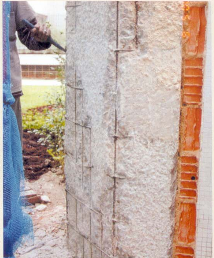
Neste pilar de edificação, com revestimento de pastilhas há contaminação generalizada por íons cloretos motivada pelas sucessivas lavagens com ácido muriático. A solução foi pela utilização de proteção catódica com corrente galvânica.
