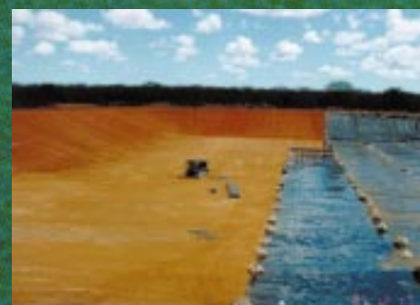
O PEAD, entre outros inconvenientes, exige muitas emendas, o que é custoso e perigoso.
