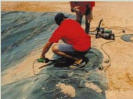
É freqüente o rasgo com posterior trabalho de emenda em geomembranas de PEAD.
