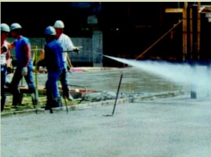
A aplicação de spray com endurecedores sobre o piso, imediatamente após a acabadora mecânica, ajuda na cura ao mesmo tempo em que promove um endurecimento do piso.
