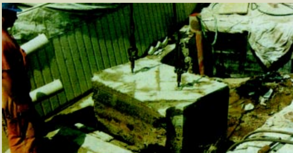
Obstáculo: um piso antigo enterrado foi cortado para possibilitar a instalação dos tirantes.
