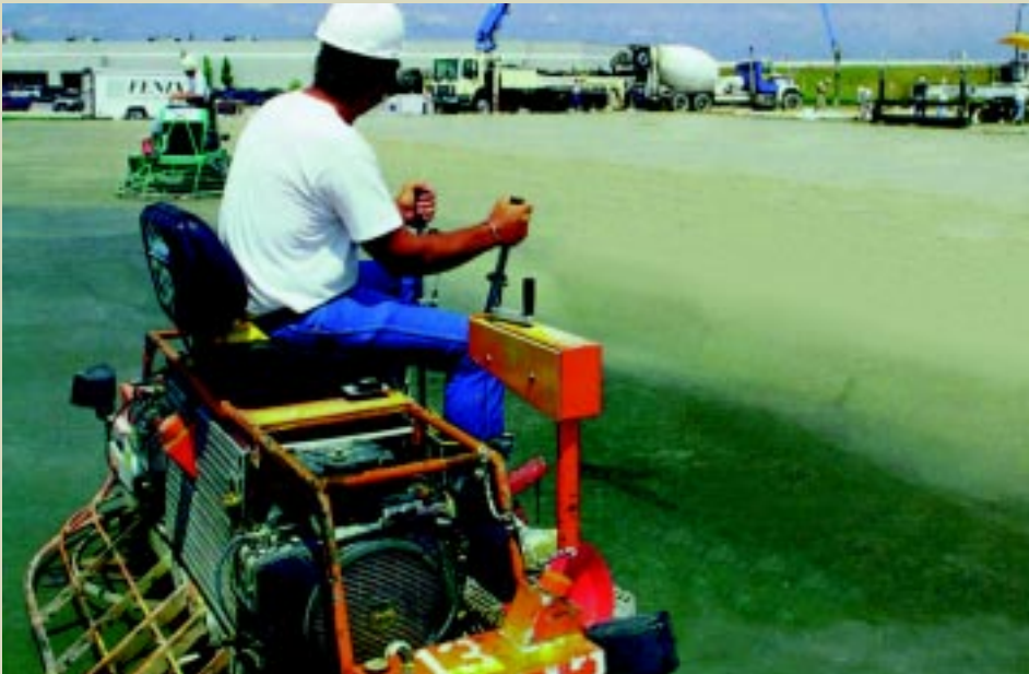
O tratamento final de grandes pisos de concreto com acabadoras mecânicas é obrigatório; assim como o seu endurecimento com produtos específicos, de modo a permitir uma boa cura e conseqüente endurecimento.
