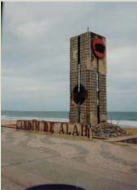
Figura 5 - Nesta torre, à beira mar, trabalhos convencionais de recuperação perpetuam a corrosão no concreto armado.
