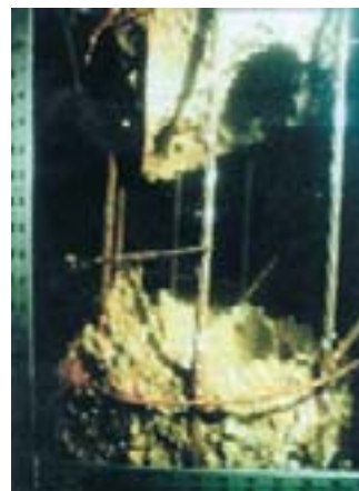
Estaca protendida com perda total de seção devido a presença de sulfatos.
