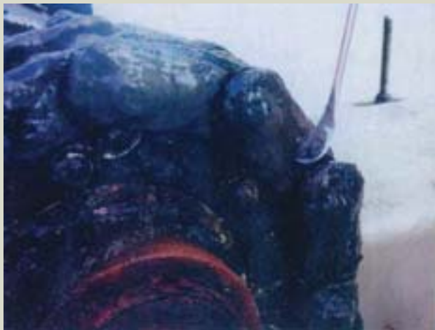
Camada de lodo sobre parte do mecanismo de acionamento do tanque de purificação ou clareamento de uma ETE. A raspagem desta camada evidenciou a presença de H 2 S e o mal cheiro característico de ovo podre. A BRS pode ser uma das culpadas pela formação deste gás.
