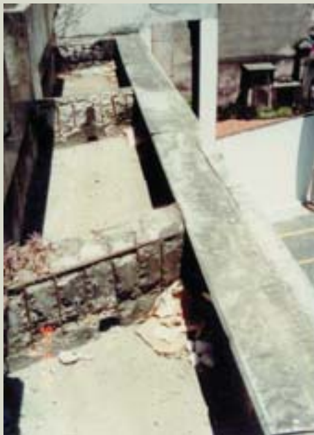
Figura 6 - Repare os vazios em torno dos estribos desta viga invertida, que contribuem para ativar o processo de corrosão.
