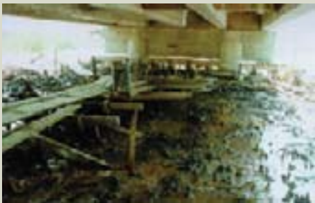
A situação dos 2 tubulões e o pântano turfoso.
