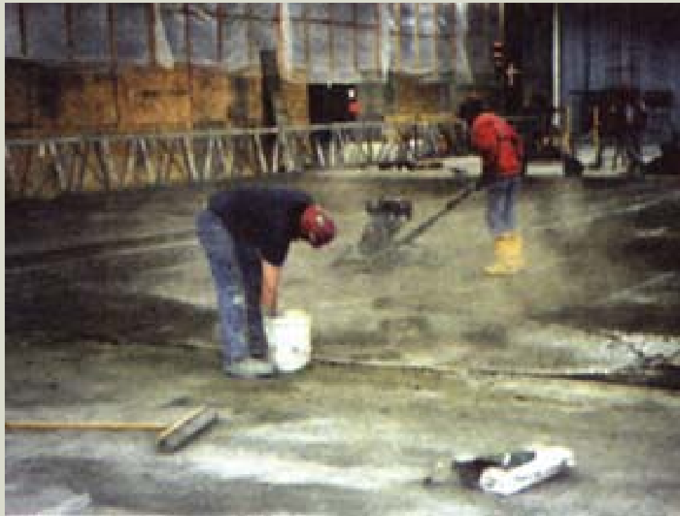
Impermeabilização com cristalização, via dry shake, em um piso de concreto submetido a processo de umidade ascendente. Repare a aspersion do pó cristalizante e a acabadora mecânica.
