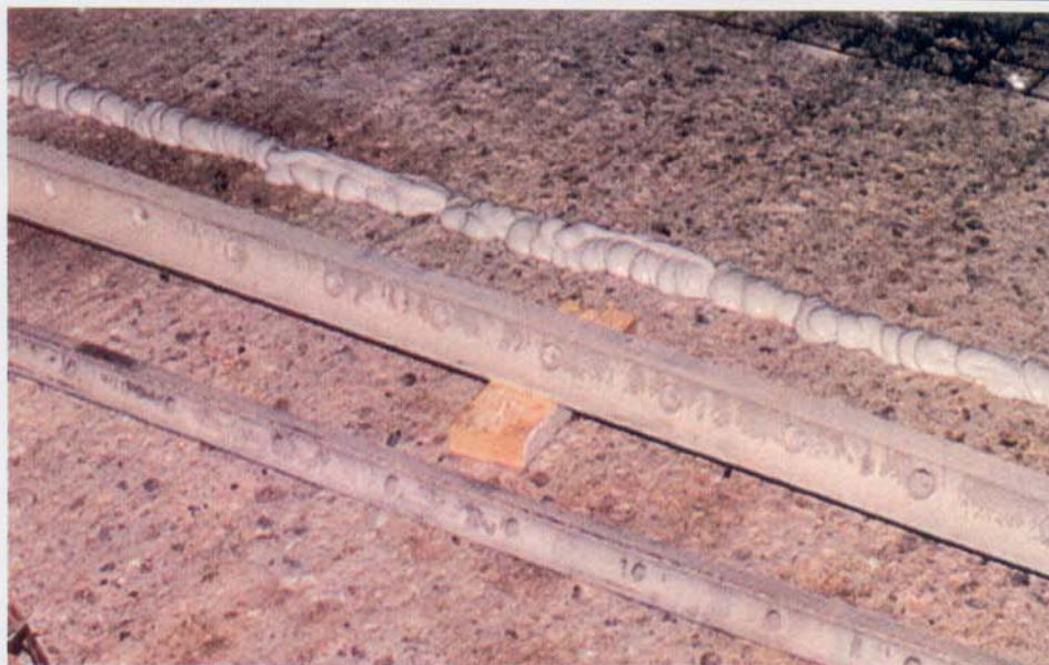
É freqüente a utilização de régua metálica de aço duro, resistente à abrasão, para limitar as laterais do overlay. Neste serviço, a espessura do overlay variou de 5 a 10cm. Após a correção do nivelamento, cola-se a régua com uma camada de epóxi.
