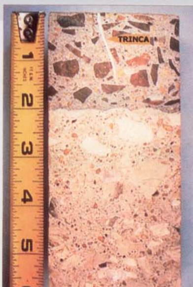
Esta trinca, monolitizada com METACRILATO, não chegou a atravessar totalmente este overlay de 5cm. É normal a surgência de trincas à medida que, por exemplo, não se intensifica o processo de cura.
