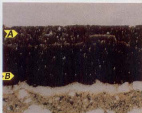
Figura 8 - Repare na mudança de cor existente na região A em relação a B. Isto indica um processo de lixiviação ou arraste das partículas de alcatrão de hulha à medida que o vapor alcança a superfície.
