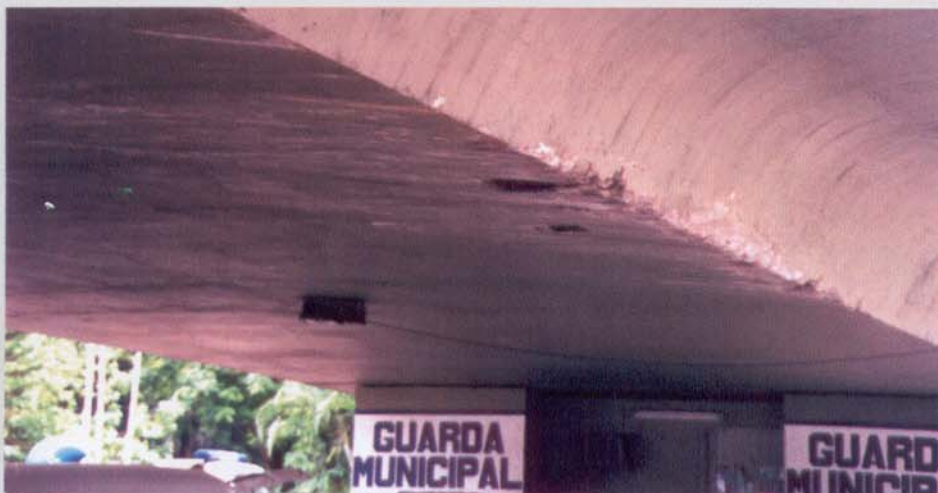
Figura 2 - viga-caixão em seção única. É muito comum impactos em sua região inferior, o que exige vistorias periódicas.
