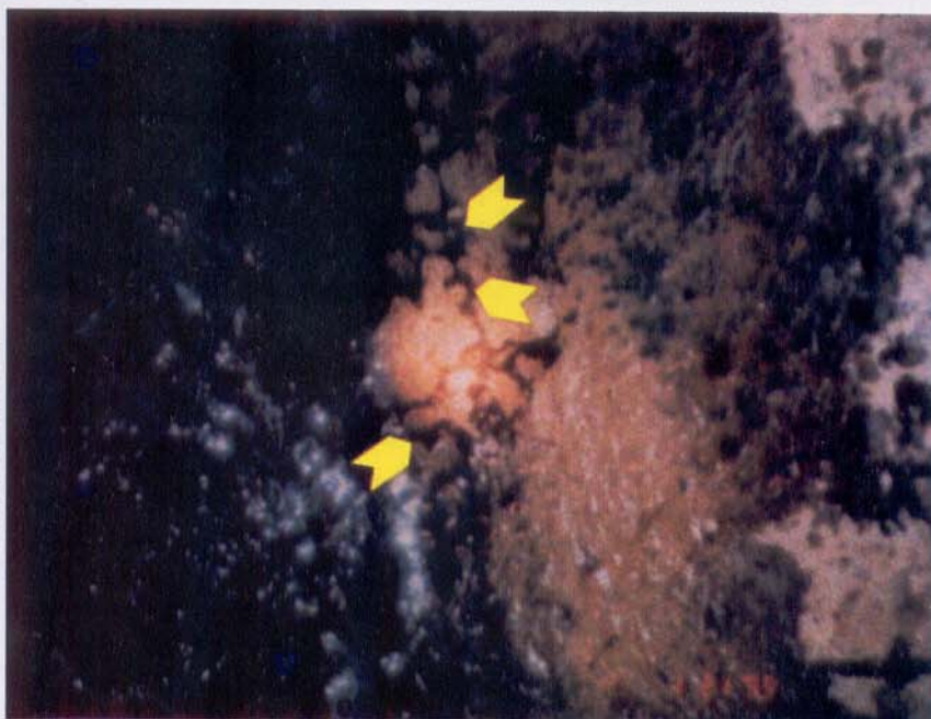
Figura 5 - Uma região da tubulação evidenciando bolhas sob a película, provocadas pela pressão hidrostática.
