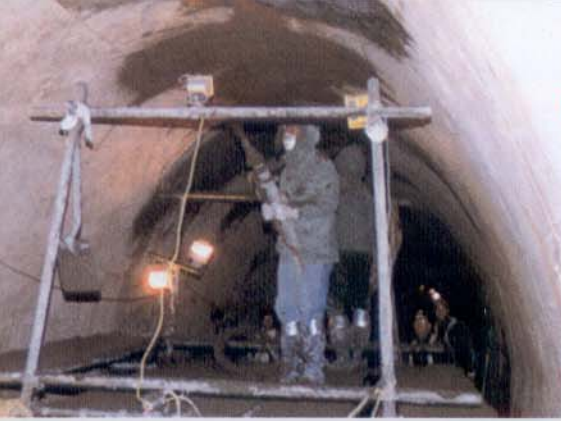
Figura 3 - Após o tratamento das armaduras com proteção catódica, foi feito o restabelecimento da seção de concreto com concreto projetado via úmida.
