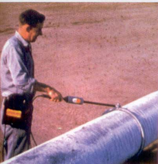
Figura 3 - Teste com o busca-furos de alta voltagem em uma tubulação de 500mm de diâmetro. Repare a ligação na mola espiralada que envolve a tubulação
