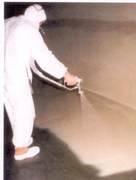
Figura 2 - Onde há a ação do H_2S torna-se necessária a aplicação de um revestimento epóxico próprio para resistir à ação do esgoto e do próprio gás.
