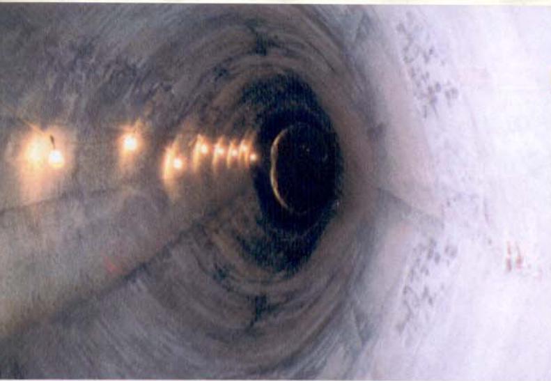
A galeria após a recuperação das superfícies e antes da pintura de proteção.
