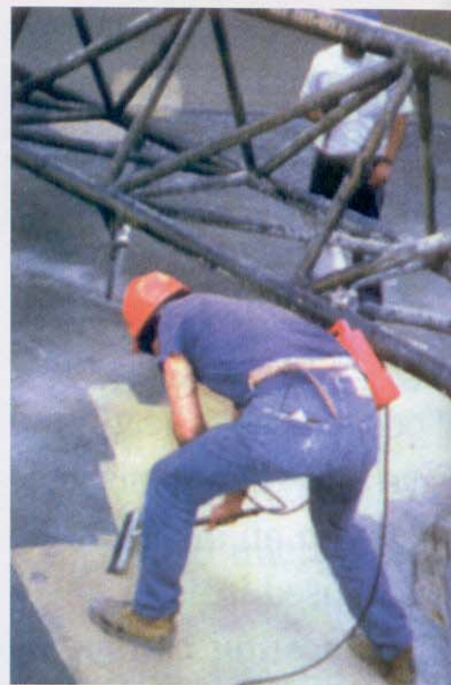
Figura 4 - O uso de BF é fundamental a todo e qualquer trabalho de impermeabilização química.
