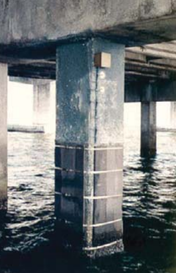
Figura 3 - Presença insipiente de corrosão na estaca. Solução simples de interrupção da corrosão com JAQUETA G, utilizando-se MALHA GALVÂNICA G e chapas plásticas de polietileno fixadas com anéis de aço inox.
