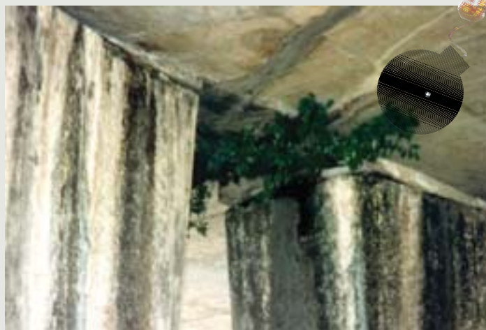
Situação típica de viadutos com penetração de água pelas juntas e pela própria laje do tabuleiro, o que provoca a descalcificação do concreto.
