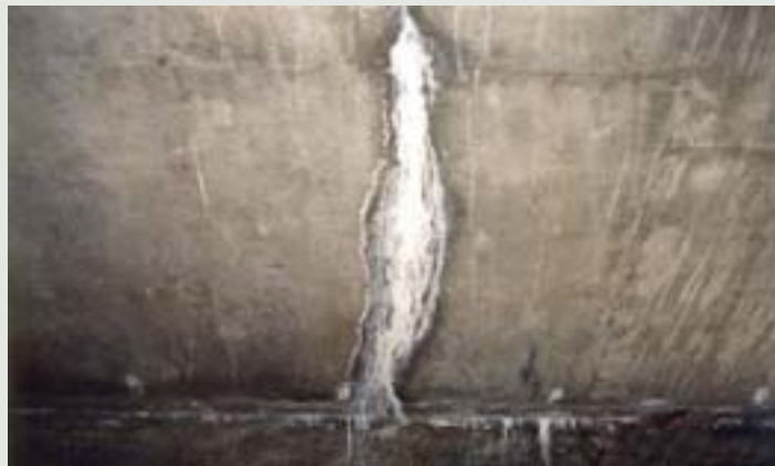
Figura 5 - Laje com grande concentração de sais provenientes da matriz cimentícia.
