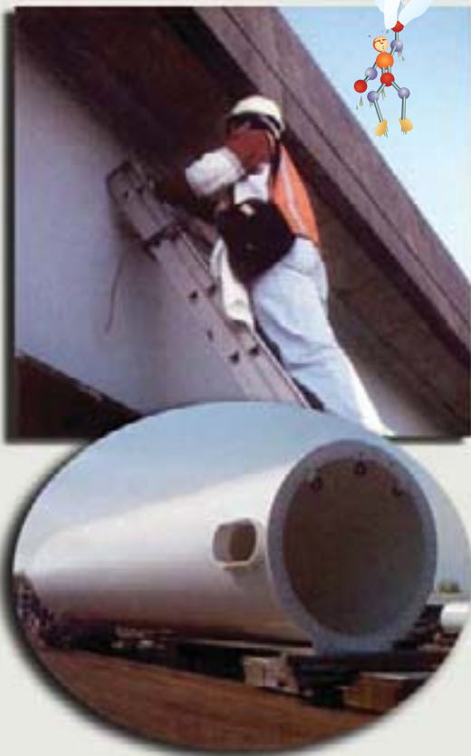
Em lon arinas metálicas de pontes ou tubulações para líquidos corrosivos, a exigência é que se verifique a presença de sais contaminantes, antes da pintura de proteção.
