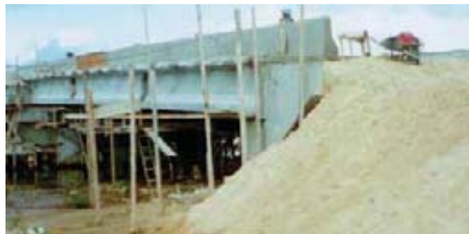
D Solo estabilizado com o grouting e os 4m de aterro sobre a turfa modificada.
