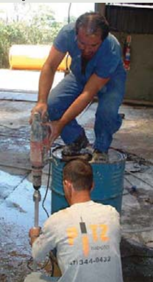
Cravação do tubo de injeção ao mesmo tempo em que é injetado o polímero.
