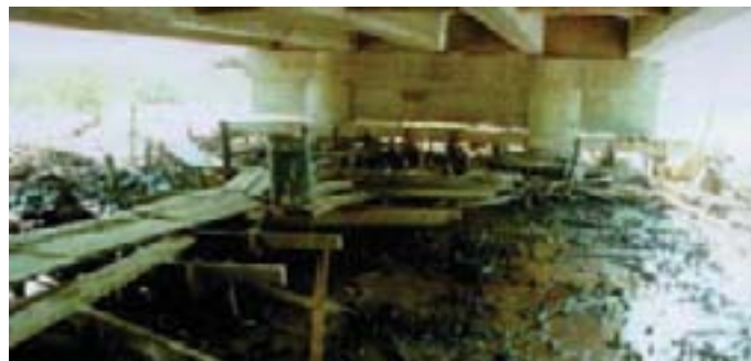
B A situação dos 2 tubulões e o pântano turfoso no limite da ponte.
