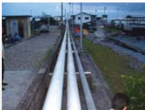
A Linha de tubulações, apoiadas em pipe-racks, e pavimento em paralelepípedos submetidos a recalques sobre argila mole.
