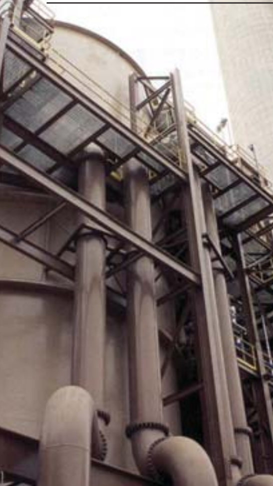
Tanques e tubulações protegidos por fora. Por dentro, é fundamental a ação do inibidor.
