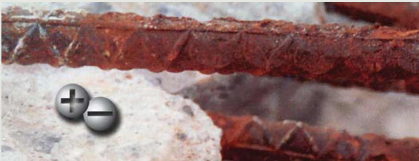
Ampliação do estado da superfície de armaduras e o desenvolvimento de pilhas de corrosão ao longo de sua superfície.
