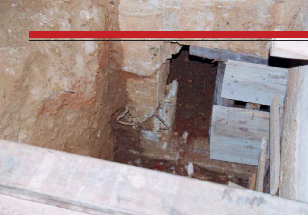
Figura 6 - Rompimento do “pescoço” do pilar enterrado, entre a cinta e a sapata. Os sintomas na estrutura superior prognosticavam tal problema. Causas: vazios no concreto (com pH baixo) e corrosão nas armaduras.
