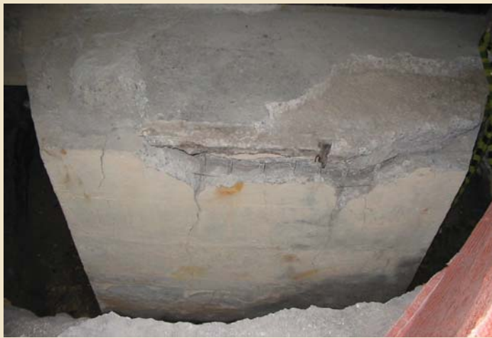
Bloco de fundação: diagnosticada a presença da RAS e a conseqüente corrosão nas armaduras.
