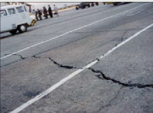
É desastroso, nos pavimentos de aeroportos, o uso de reparos feitos à base de cortes biselados e preenchimento com argamassas pré-fabricadas.
