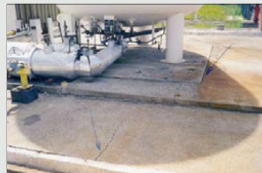
Da mesma forma nos pavimentos que cercam tanques e depósitos químicos. Em pouco tempo, a argamassa de recuperação descola em uma das bordas ou simplesmente deslaca, expondo o solo ao material contaminante.
