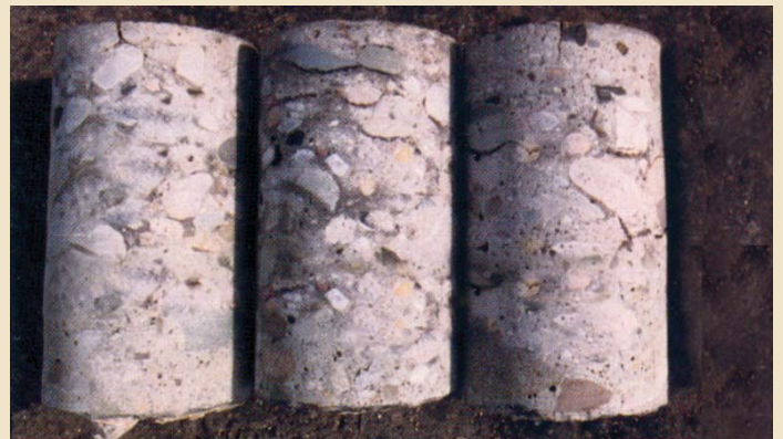
Corpos de prova (CPs) extraídos de blocos de fundações de um prédio sintomático. Repare na quantidade de trincas na região superior dos CPs, tipificando a RAS, previamente detectada com o detector de reatividade RAS. O alto nível do lençol freático é percebido pela presença da água em torno das trincas, o que exacerba o ataque, de fora para dentro, pela introdução da água a partir da superfície.
