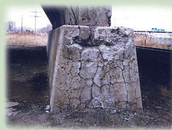
Bloco de ponte com reatividade.
