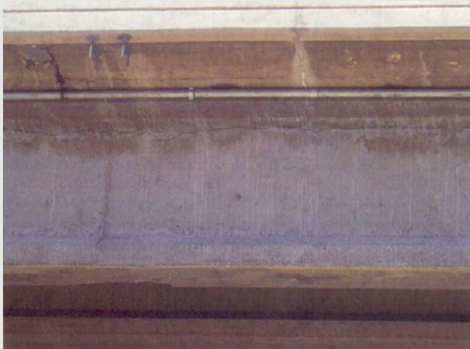
Figura 2 - A viga I antes da monolitização com epóxi de ultra baixa viscosidade.
