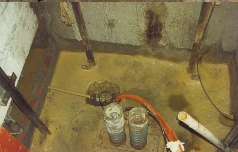
Figura 2 - A análise da água, presente em poços de elevadores, nos dá uma boa idéia da água que envolve os elementos de fundação.
