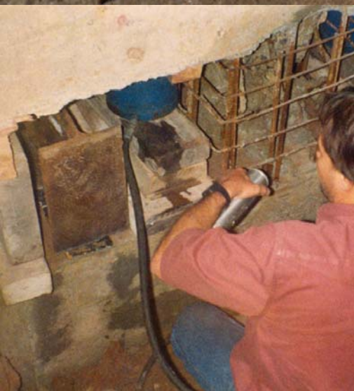
Figura 4 - Este “pescoço” de pilar, situado entre a sapata e a cinta de fundação, literalmente desintegrou-se pela ação freática corrosiva. Daí a necessidade do macaqueamento seguido do aumento da seção daquele trecho do pilar.
