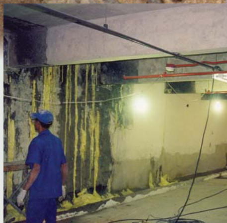
Figura 5 - Neste subsolo, a cerca de 10m de profundidade, a solução salina infiltrante pelas paredes provocam sérios problemas no concreto e em suas armaduras. Houve a necessidade da impermeabilização, com resina hidroexpansiva PH FLEX, junto a interface solo-concreto, de modo a tirar a solução corrosiva do interior do concreto. A injeção foi naquela interface. Foi usada proteção catódica, no concreto contaminado, para neutralizar o processo de corrosão nas armaduras.
