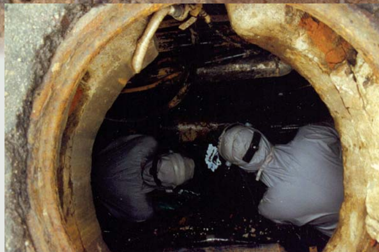
Figura 3 - É freqüente, no interior de caixas de telefonia ou de luz, depararmos com todo tipo de soluções presentes também no solo.
