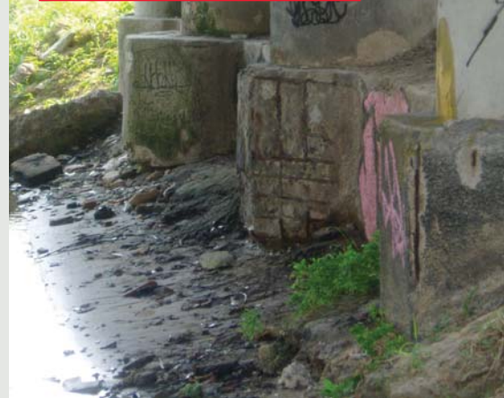
Figura 6 - Na foto maior, a base dos pilares de uma ponte onde, na foto menor, fica evidente a presença de sais sulfatos.
