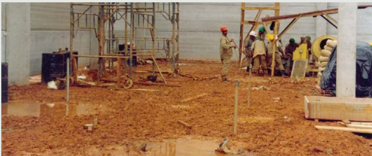
Figura 3 - Nesta área de uma indústria havia uma camada de argila mole entre 4 e 7m de profundidade. Foi feita a consolidação desta argila com COMPACTION GROUTING, de modo a dar estabilidade ao futuro piso para um depósito.
