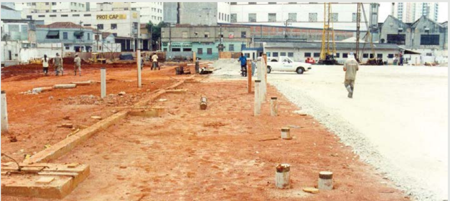
Figura 4 - Logo este solo aguentará cargas pesadas. Caso não esteja bem dimensionado, poderá comprometer o piso de concreto, os blocos e até suas estacas.
