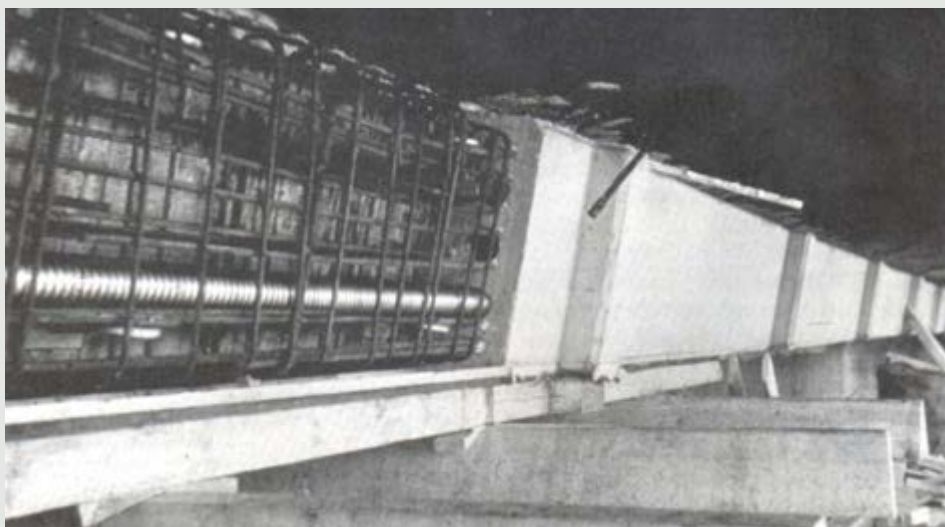
Figura 4 - Reforço da viga caixão com cabos protendidos externos embutidos na viga de concreto.
