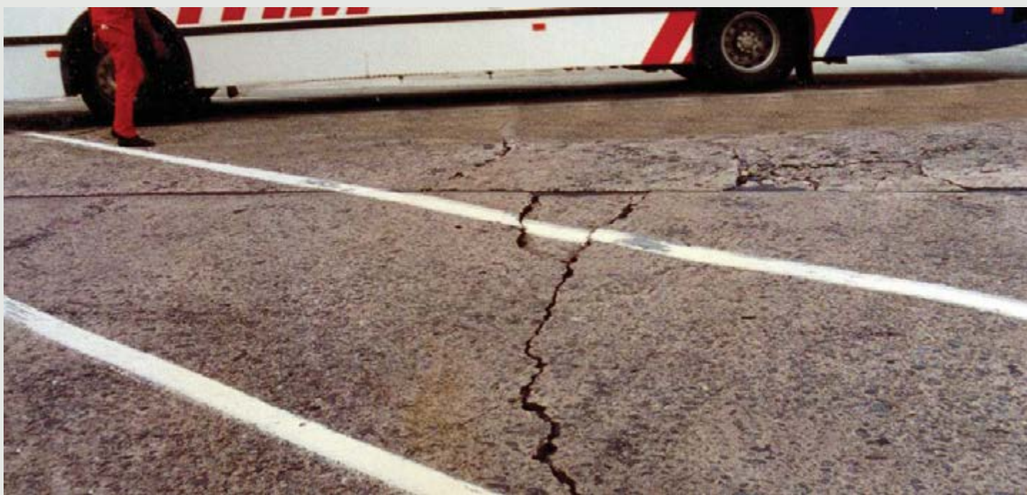
Figura 2 - subleitos mal dimensionados ou preparados não suportam as cargas previstas, promovendo fraturas no piso. Juntas mal dimensionadas e nada estanques pioram ainda mais o problema.
