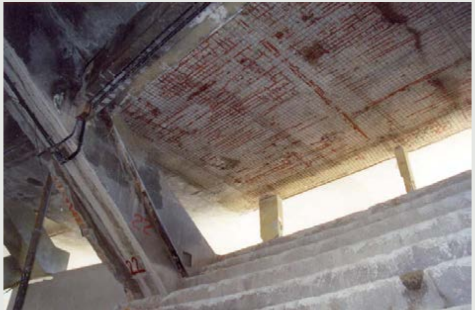
Figura 6 - Neste estádio “tratou-se” a armação original e corroída da laje com “pintura anticorrosão”.
