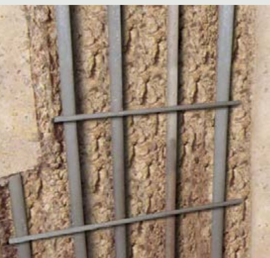
Figura 3 - Pintura epóxica rica em zinco aplicada sobre as barras corroídas (antigos anodos). As regiões bem pintadas tornam-se catodos. As regiões mal pintadas, como furos na película e por trás das barras continuam anodos, agora corroendo de forma mais intensa pelo fato de concentrarem mais corrente. As regiões "aparentemente boas" e que não foram pintadas, antigos catodos, que fomentavam os antigos anodos, passam a ser novos anodos. A inclusão de partículas de zinco em meio epóxico simplesmente não funciona como trocador galvânico.
