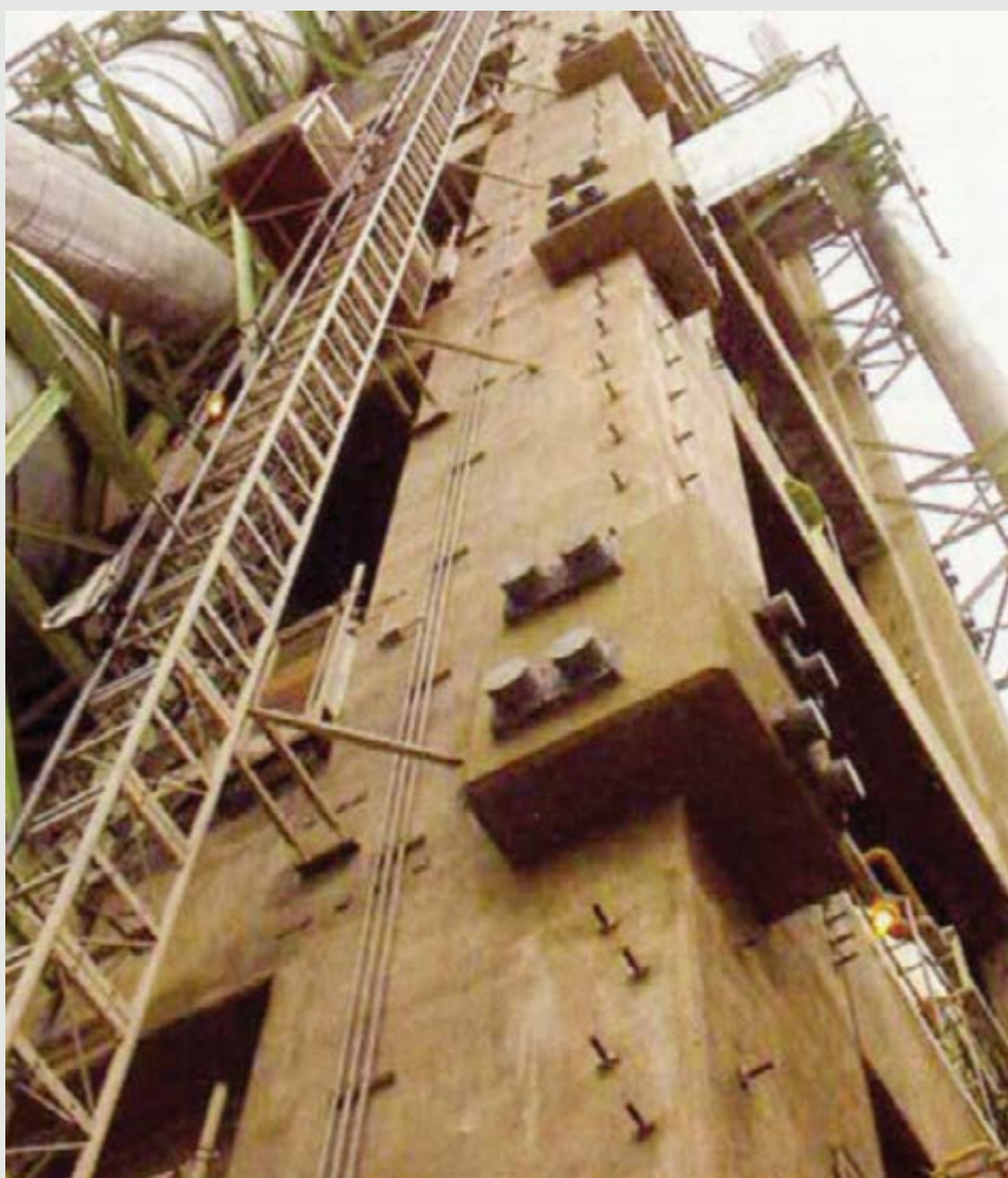
Figura 1 - Vista de uma torre de pré-aquecimento após a execução do reforço com protensão. Barras de ancoragem foram instaladas em cada um dos lados dos pilares de quina da edificação, em cada um dos pavimentos, de modo a aumentar a resistência ao cisalhamento imposto pelas cargas laterais.
