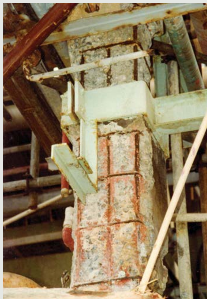
Figura 4 - Também nesta estrutura o tratamento anterior com "pintura anticorrosão".
