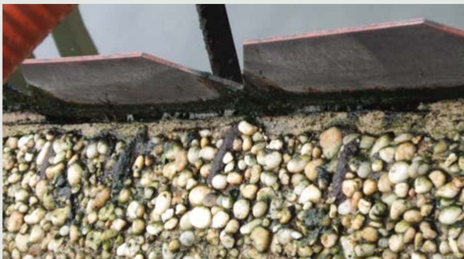
A matriz cimentícia do portland não sobreviveu à ação contínua do despejo: agregados à vista.
