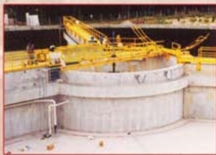
Superfícies de concreto armado-protendido novas, sem qualquer proteção ou, quando muito, com revestimentos "baratos" inspecíficos contra a ação de despejos extremamente corrosivos...
