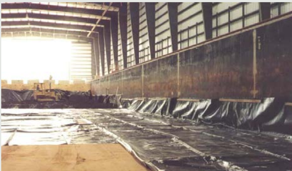
Nível d'água muito próximo à superfície é problema. A barreira contra a umidade ascendente deverá ser eficaz.
