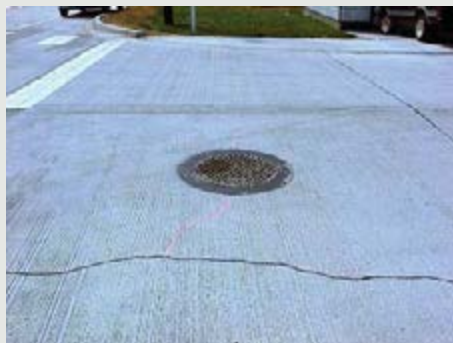
Trinca de retração devida ao corte tardio da junta.
