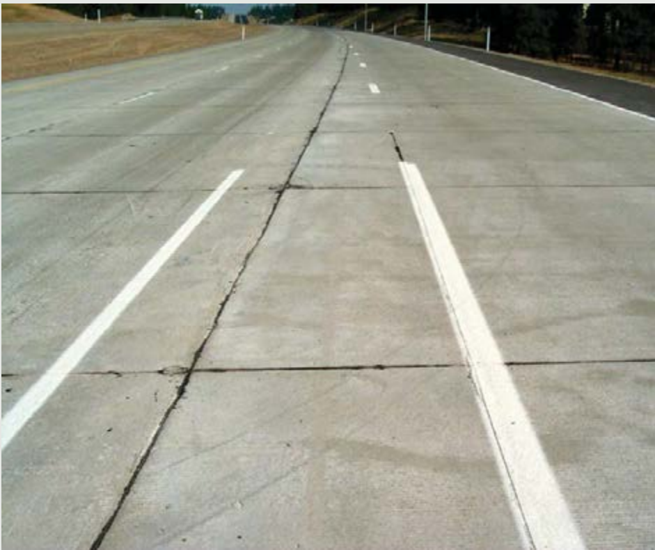
Trincas em pavimentos de concreto são fatais para sua durabilidade.
