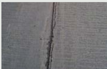
Esborcimento ao longo da junta devido ao corte prematuro da mesma.
