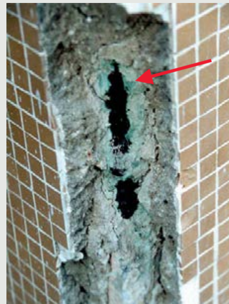
Figura 8 - Nesta foto está claro o tratamento feito há cerca de 6 anos atrás, com “pintura inibidora de corrosão em base polimérica”. Repare o estado da armadura e a presença ainda do produto.
