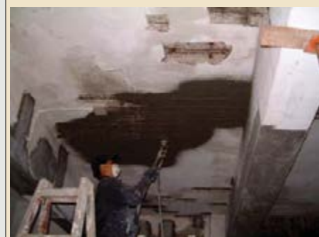
Figura 4 - Nesta seqüência de fotos observa-se a sistemática tradicional deletéria de "recuperação estrutural" nas armaduras do concreto de lajes e vigas: Corte do concreto, aplicação de "pintura inibidora" e projeção de argamassa.
