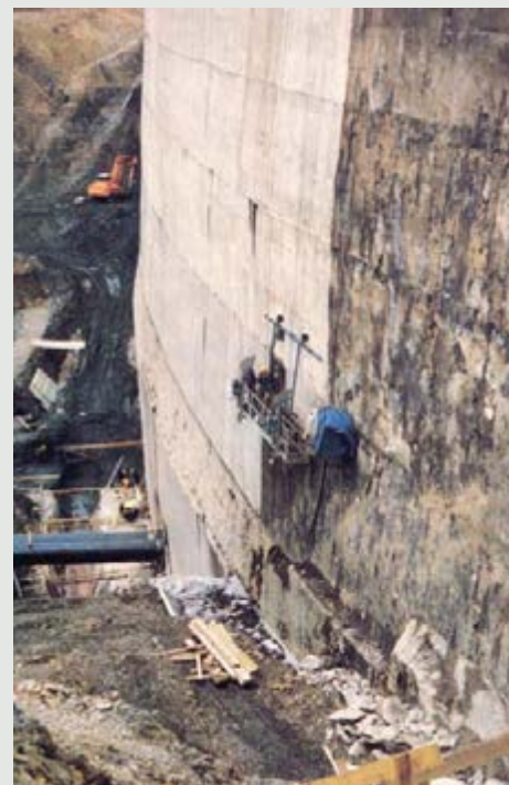
A preparação de superfícies verticais é cada vez mais rápida e eficiente com o uso de hidrojetadores alimentados com areia.
