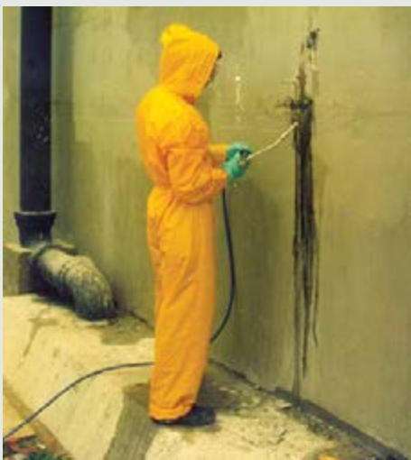
Na impermeabilização com resina hidroexpansiva utiliza-se a resina de células fechadas (PH FLEX SUPER) no lugar da de células abertas, economizando tempo e dinheiro. As bombas de aplicação também são pequenas e elétricas sem necessidade de compressores.
