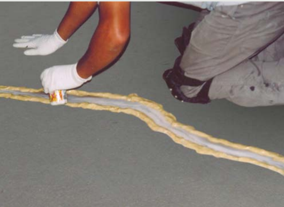
O surgimento de fissuras e até trincas deve ter como tratamento a aplicação de adesivos de ultra baixa viscosidade por gravidade, tipo METACRILATO ou PP50.
