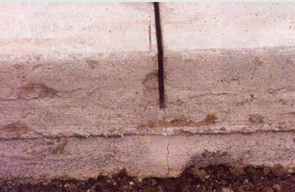
Junta serrada (ou de controle) já com a ocorrência de trinca induzida.
