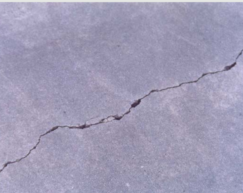
A ocorrência de fraturas no piso é, infelizmente, comum devido a ausência de cavidades na preparação do subleito/sub-base.
