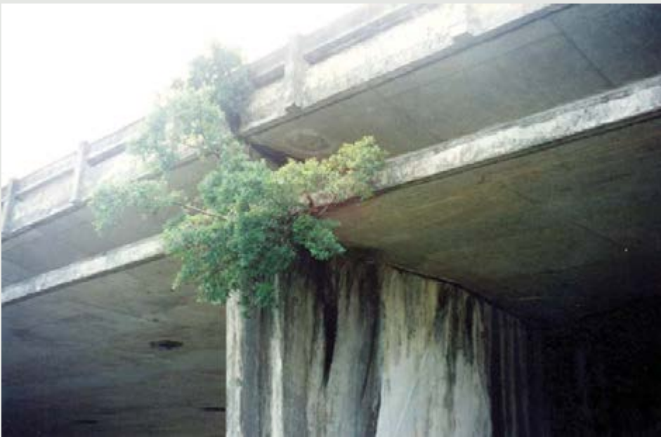
Viaduto carioca com presença de biofilme ao longo da região superior do pilar.
