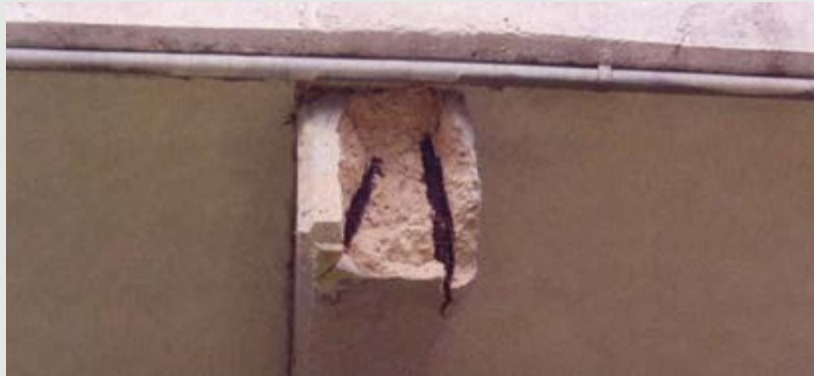
Desplacamento na ponta da viga que sustenta a marquise.
