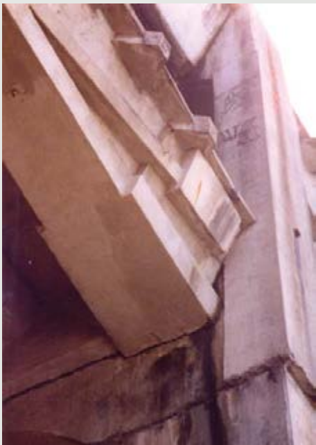
Presença de biofilmes nas travessas do viaduto do Joá, no Rio de Janeiro, devido aos vazamentos nas juntas de dilatação.
