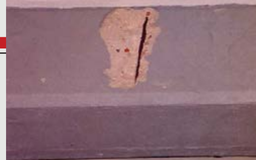
Desplacamentos evidenciam a presença de corrosão: a causa é a carbonatação.
