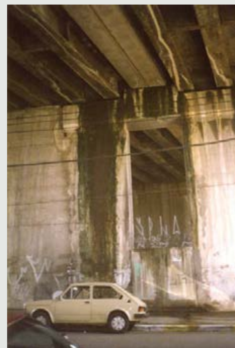
Figura 8 - Viaduto Com. Elias Nagib Brein, em São Paulo, evidenciando presença de biofilme ao longo da travessa e pilares.
